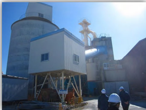
写真ー1 戸田建設株式会社 成田PC工場内 コンクリート製造設備
