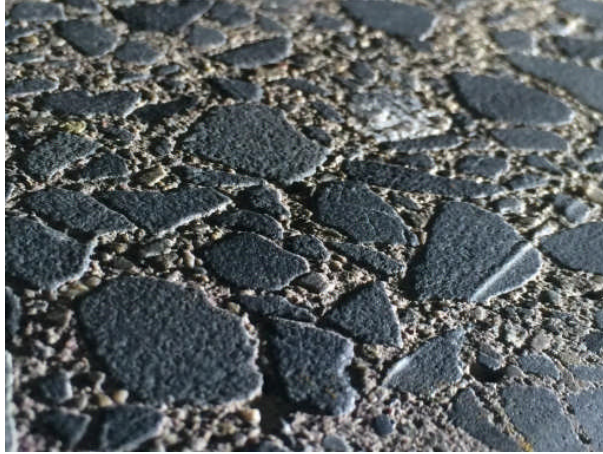
写真 6.4.2.1 実験終了後の表面の写真(A20)
