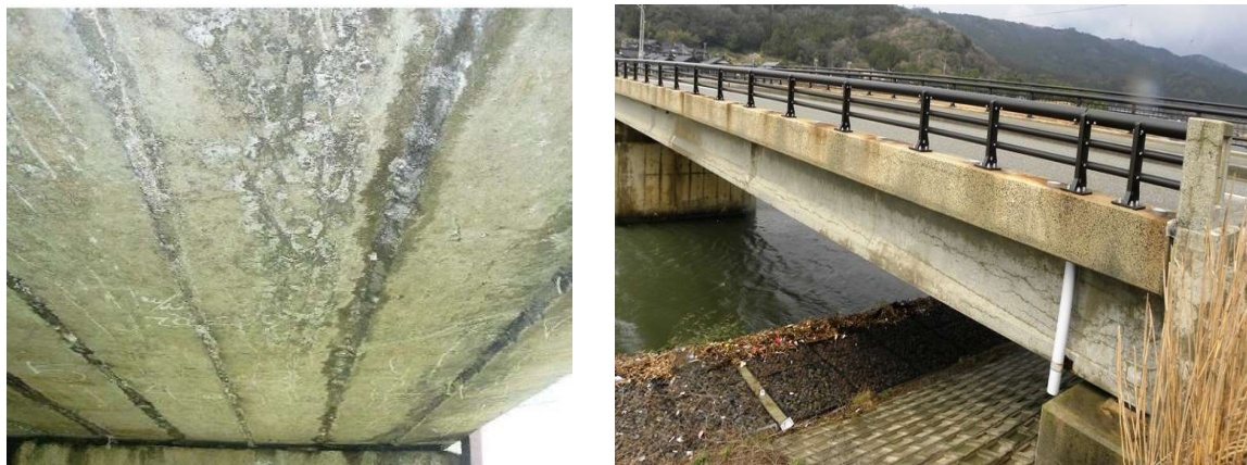
写真 5.3.1 ASR により PC 桁下面（左）および側面（右）に生じたひび割れ
