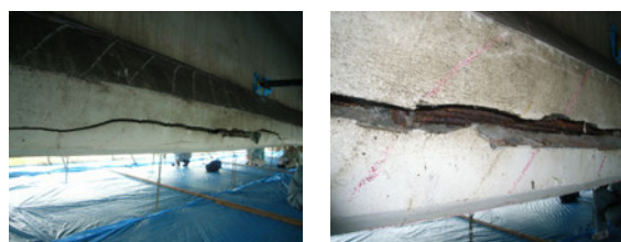
写真 3.2.2 PC 桁下フランジ部の劣化状況
