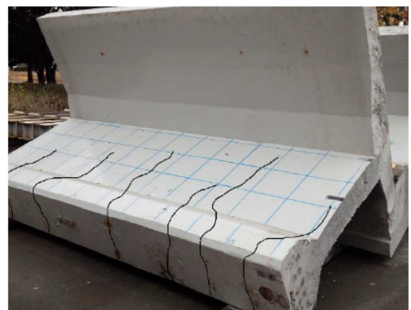
付写真 6.2 G4 桁支間中央付近の撤去桁のひび割れ状況
