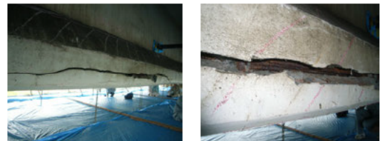
付写真 3.2 PC桁下フランジ部の劣化状況
