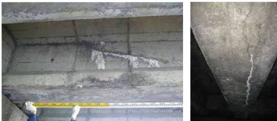
付写真 4.2 撤去前の外観変状
