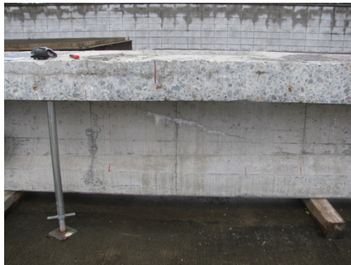
(a) シースに沿ったひび割れの発生状況
