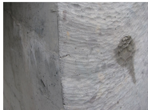
(d) シースに沿ったひび割れへの水の侵入状況
