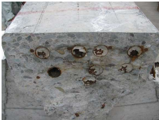
(a) ひび割れの発生状況
