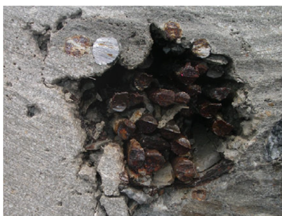
写真3.2.5 第1径間G3桁C3ケーブル(充填度4)
