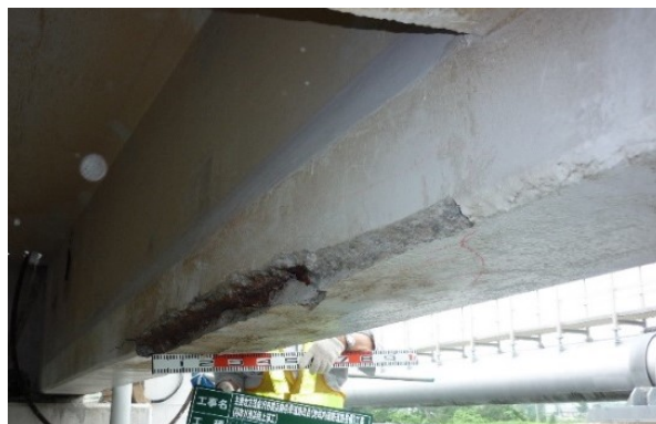
付写真 2.2 損傷状況
