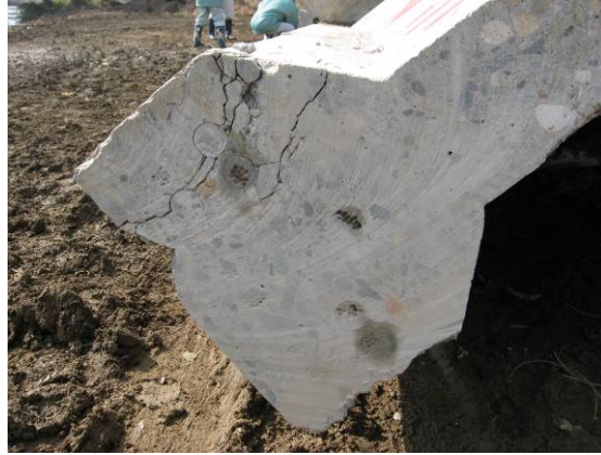
付写真 1.4 下フランジに見られたひび割れ
