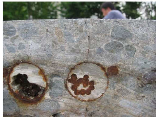
(b) 部材内部のひび割れ状況
