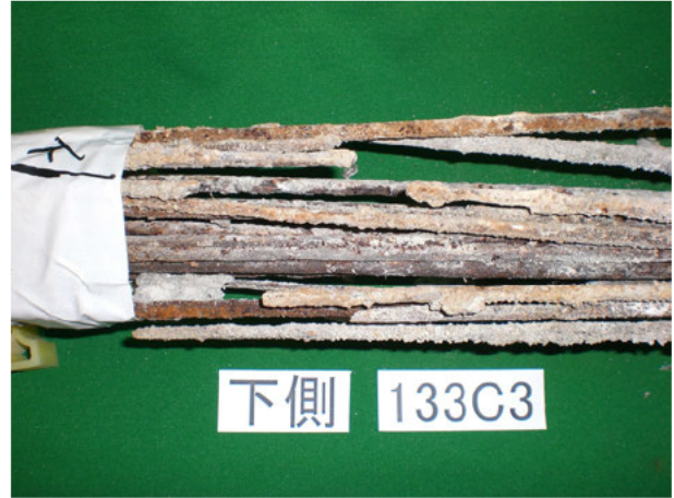
b)PC 鋼材の破断
