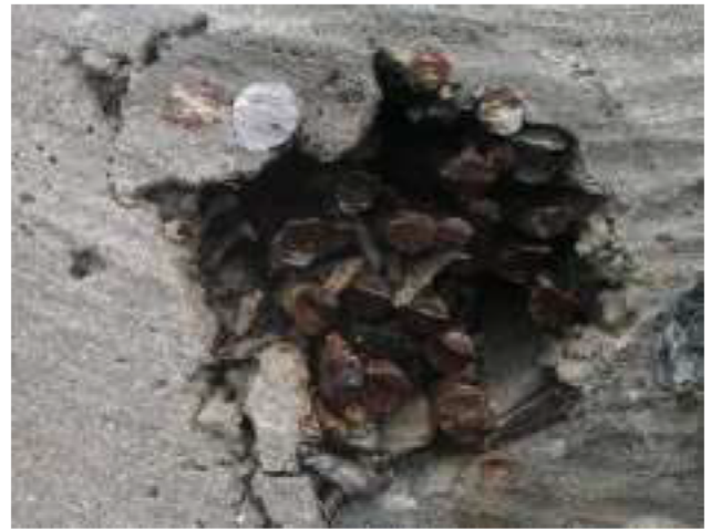
付写真3.5 グラウト充填度4 (第1径間G3桁③)
