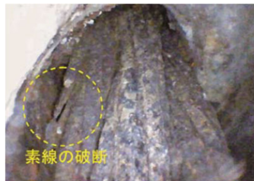
写真 1.1.2 P1 付近のシース内の状況 1-1)
