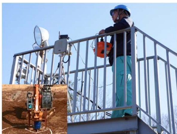
Fig. B-15 やぐらでのオペレータの操作状況
