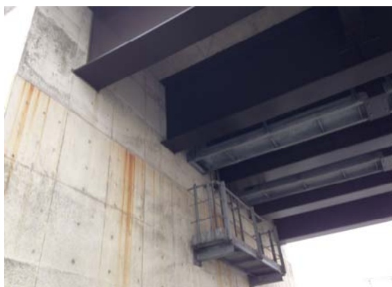
写真 6.1.1 さび汁による橋台の汚れ
