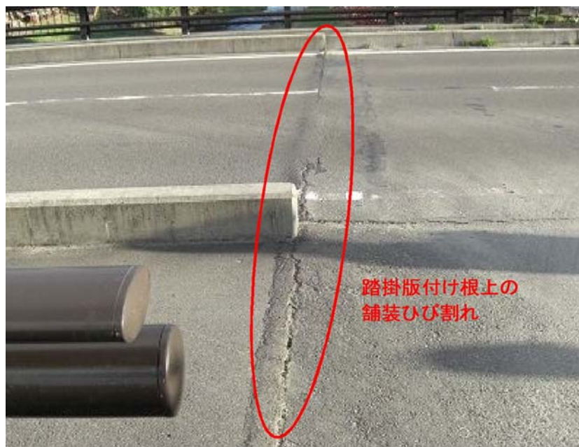
写真 6.3.1 踏掛版境界上の舗装ひび割れ状況
