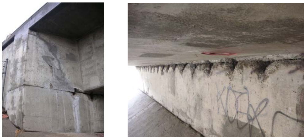
写真 1.1.2 斜角を有する橋梁での損傷事例
