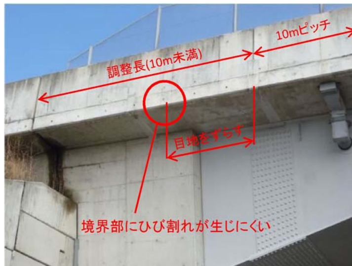
写真 6.2.1 壁高欄目地位置を埋込み境界部からずらした例
