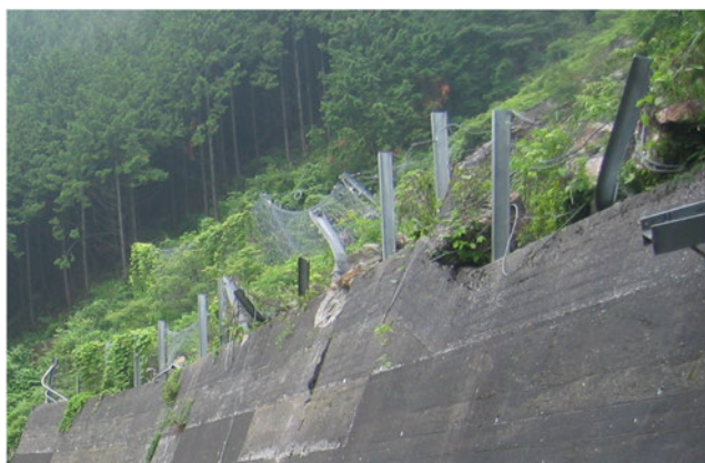
写真 2.2.11 落石による防護柵の損傷その1
