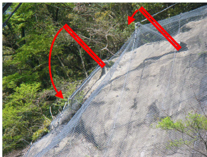
損傷状況 3 支柱の倒れ込み(落石直撃)
