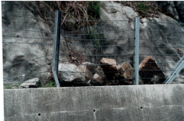
捕捉・損傷状況 正面
