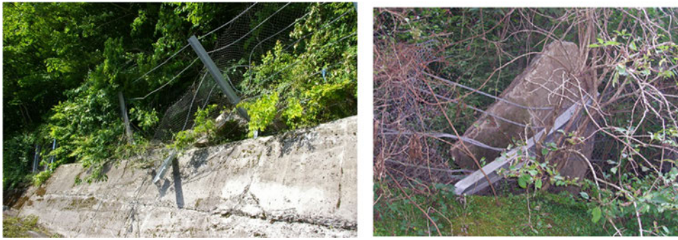
写真 2. 2. 13 落石による防護柵の損傷その3
