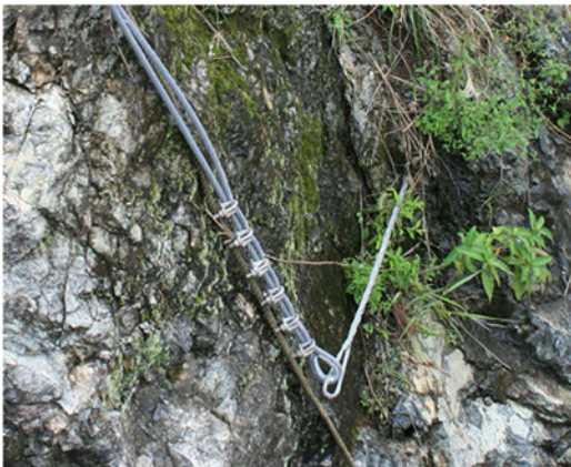
写真2.2.7 巻き付けグリップの引き抜け
