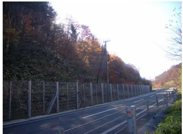
写真 2.1.2 落石防護柵の例
