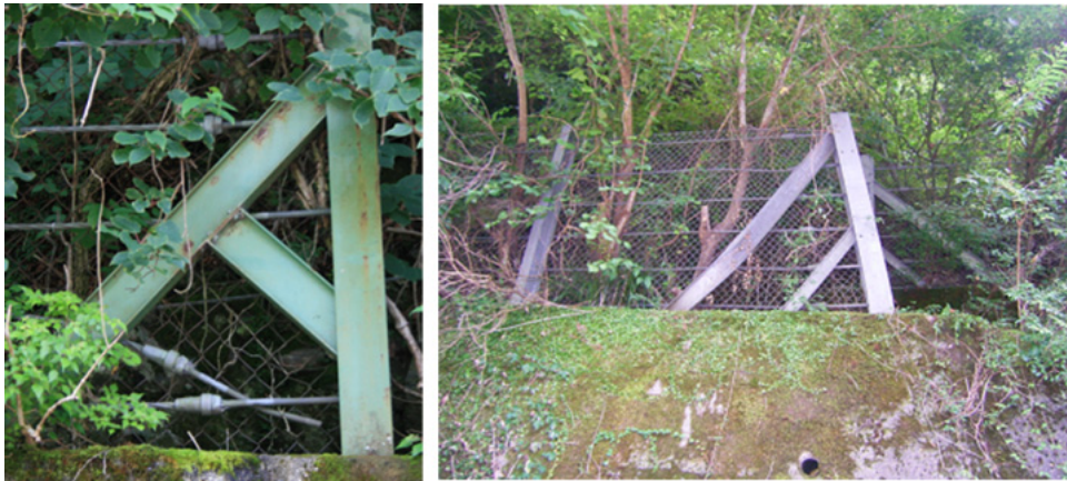
写真 2. 2. 14 落石による防護柵の損傷その4
