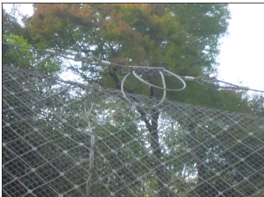
緩衝装置（ブレーキエレメント）の作動は殆どなし
