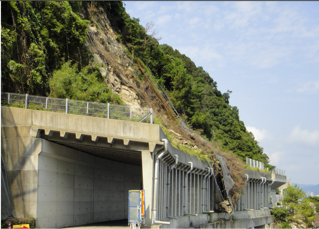
捕捉・損傷状況 全景
