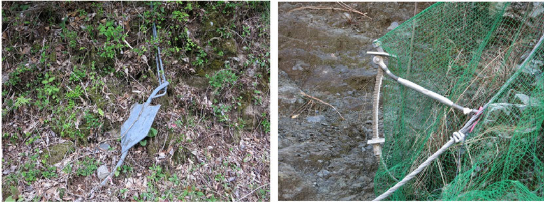
写真2.2.3 アンカーの引き抜け
