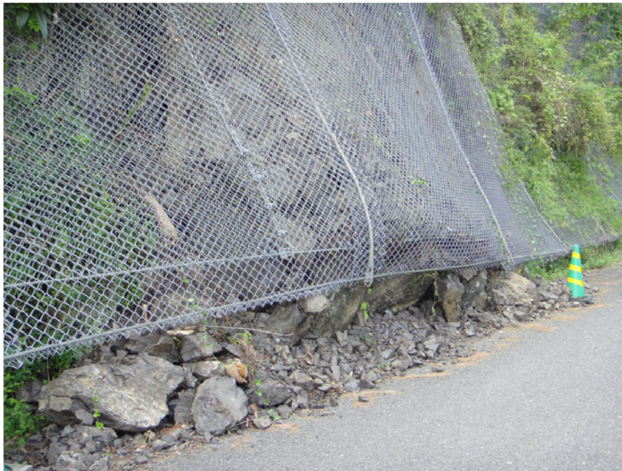
捕捉・損傷状況 2 金網変形
