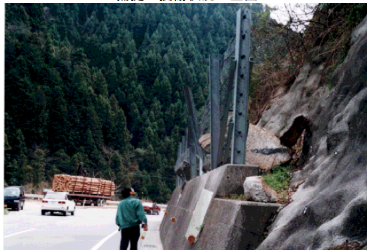
捕捉・損傷状況 側面
