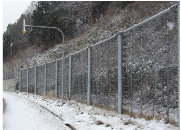
写真 1.2.5 支柱強化型柵の例
