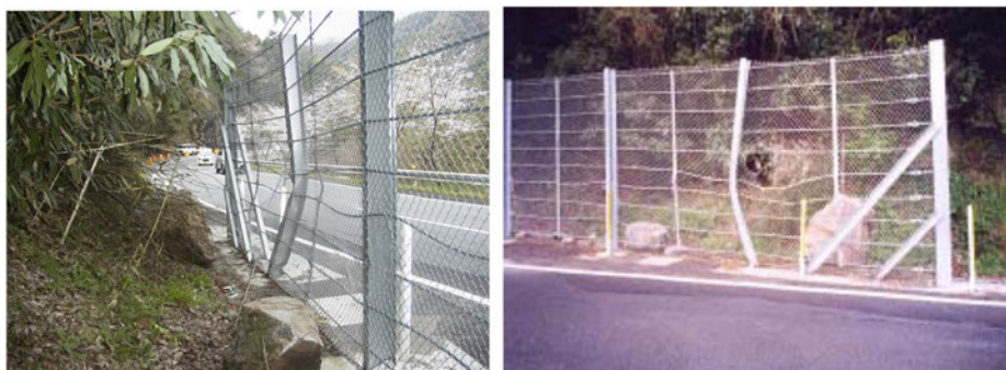
写真 2.2.12 落石による防護柵の損傷その2
