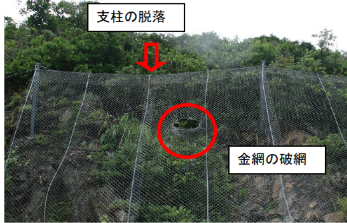
損傷状況 1 金網の破網, 支柱脱落
