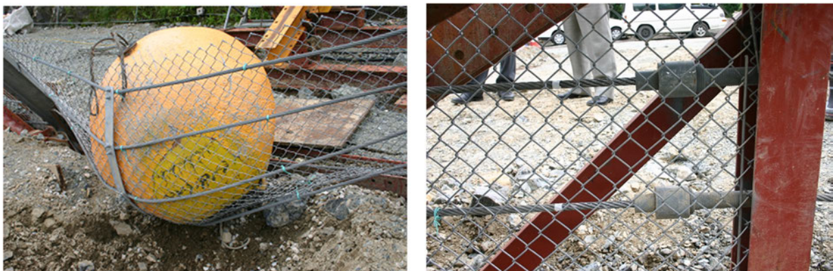
写真 2. 3. 7 ワイヤロープが緩衝金具の中をスリップして落石エネルギーを吸収
