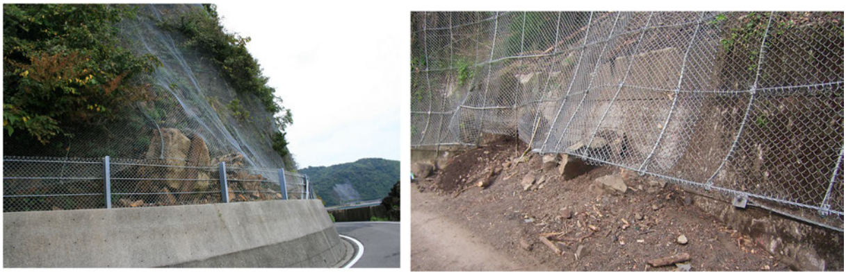
写真 2.2.2 裾部からの転がり出し
