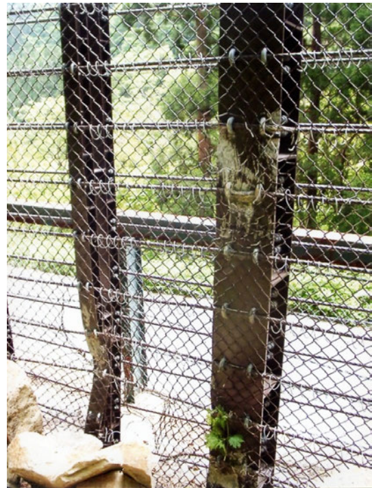
衝突部変形状況
