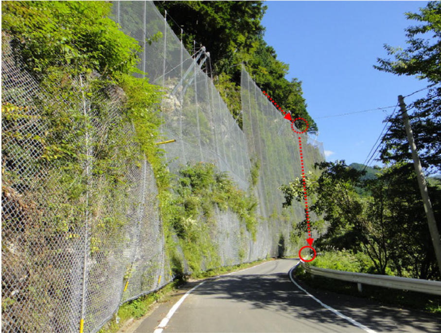
捕捉・損傷状況 1 全景
