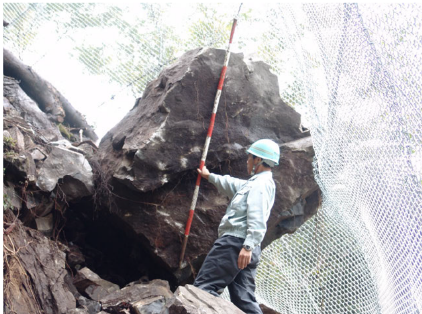
捕捉・損傷状況 2 金網変形・一部破網
