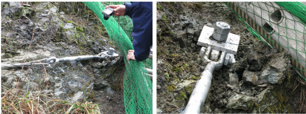
写真2.2.6 アンカー埋め込み部の岩盤の破壊
