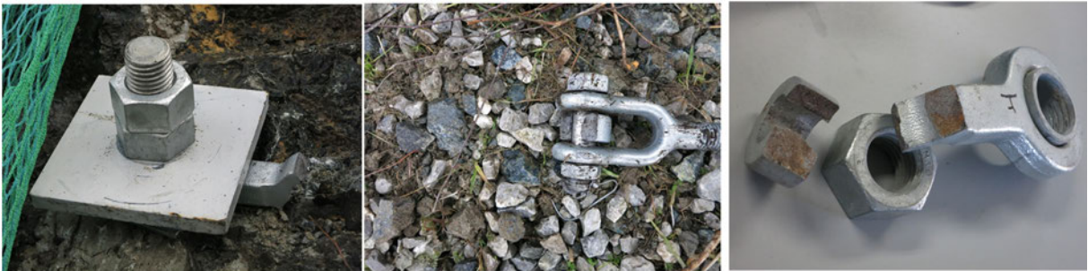
写真2.2.5 ターンバックル取り付け金具の破断(アンカー一部)
