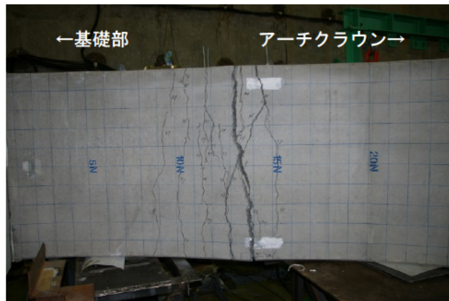
写真-3.3.7 水平荷重載荷点の破壊状況（写真-3.3.6の内側の状況）
