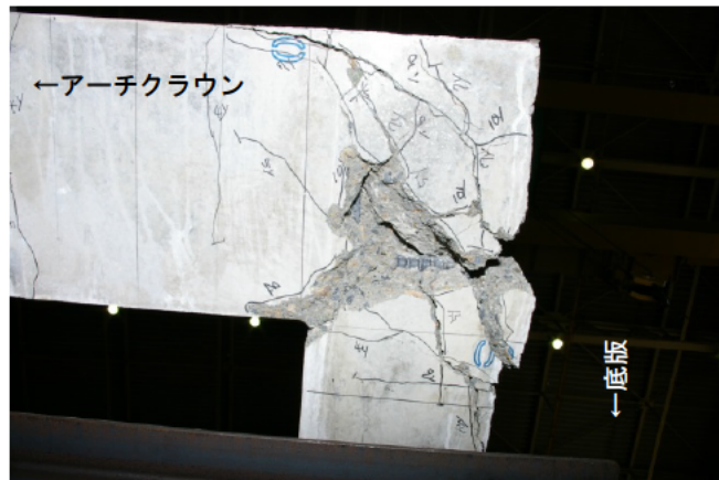
写真-3.1.7 隅角部損傷状態（下面から撮影） 下面側にはコンクリートの剥落が確認された
