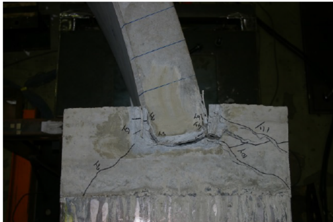
写真-3.3.5 基礎部終局状況 (写真-3.3.4の反対側)
