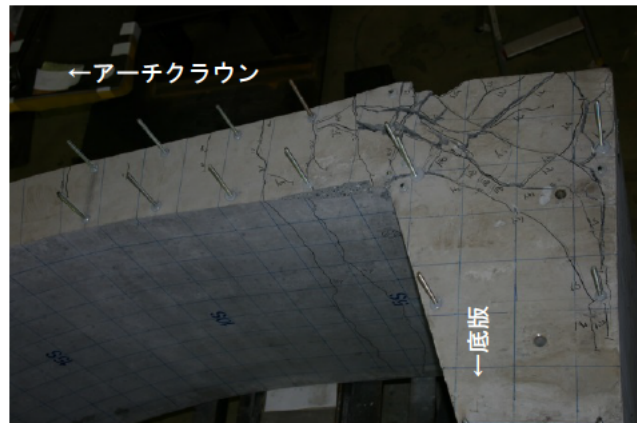
写真-3.2.3 隅角部損傷状況（上面からの撮影） 隅角部にクロス状のひび割れを確認
