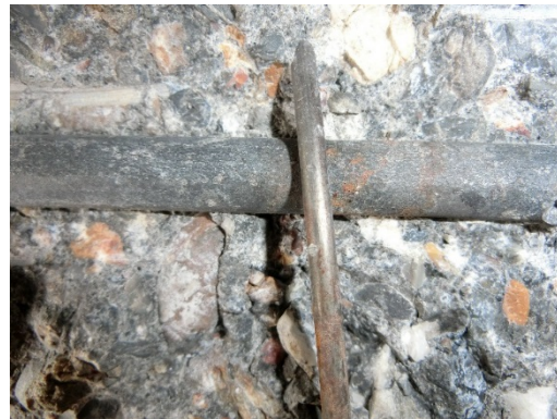
(b) 軸方向鉄筋 No.3-2300mm 付近
