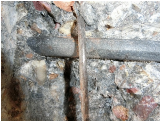
(a) 軸方向鉄筋 No.3-2200mm 付近
