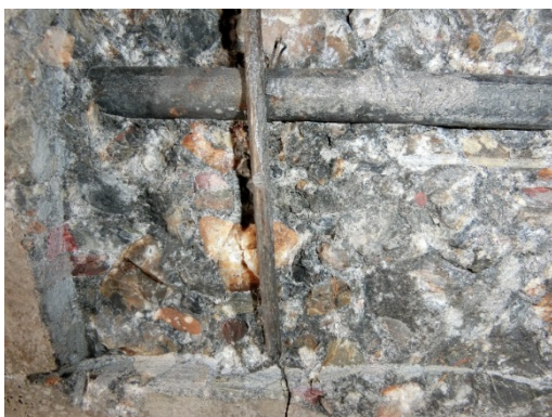
(e) 軸方向鉄筋 No.4-2200mm 付近
