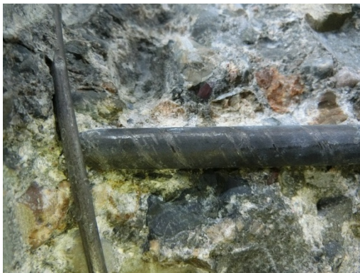
(b) 軸方向鉄筋 No.5-1600mm 付近
