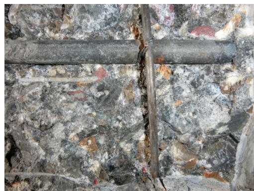
(f) 軸方向鉄筋 No.4-2300mm 付近
