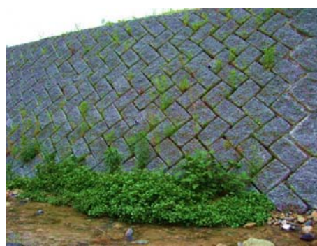
写真-3.11 目地が深く（黒く） 目地から植生がある
