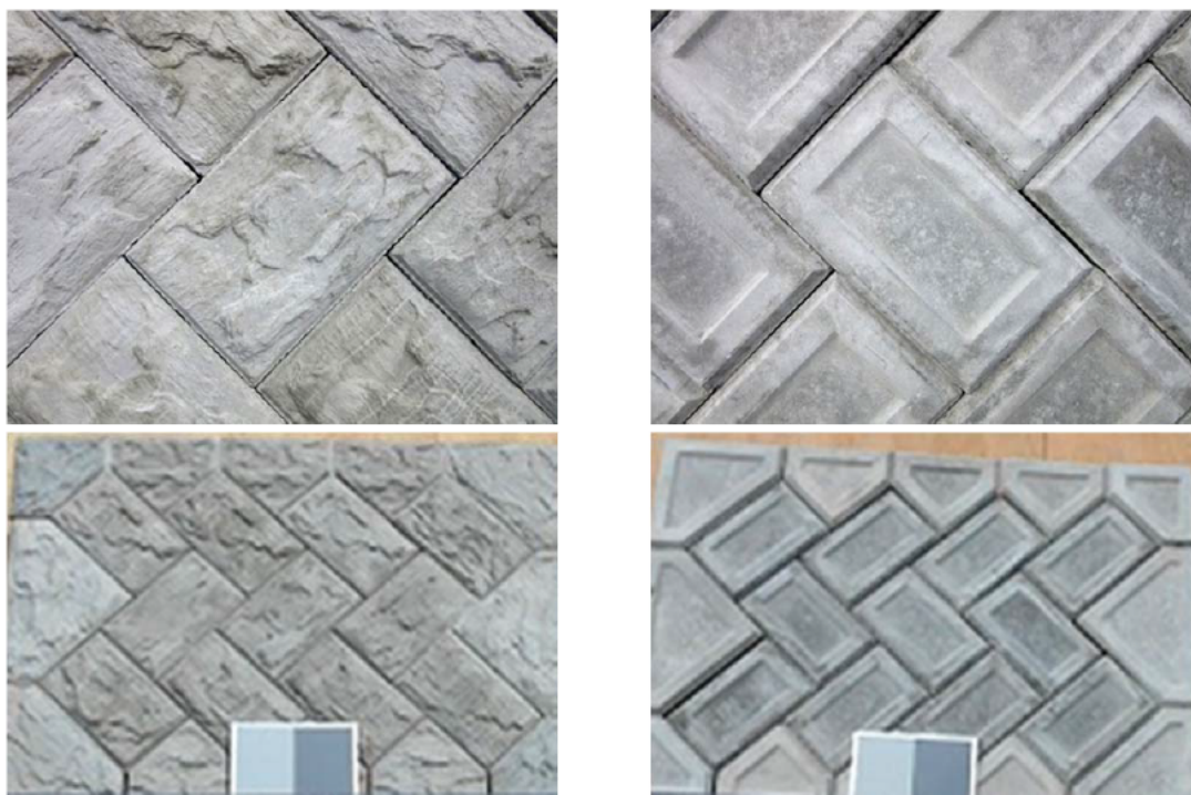
写真-6.35 汚れ、色ムラの例
