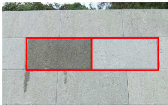
写真-6.11 左：湿潤状態 右：乾燥状態
