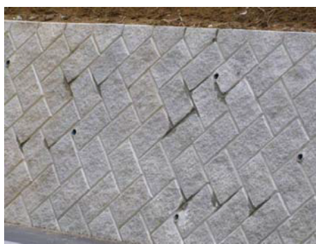
写真-3.10 目地が広く（白く） 目地から植生がない
