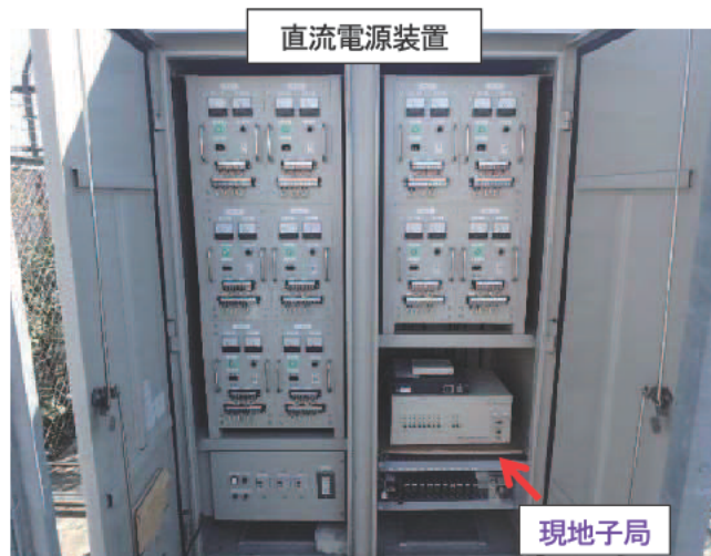
写真-1 現地子局の外観
