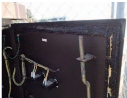
写真 1.5 ゴムパッキンの劣化
