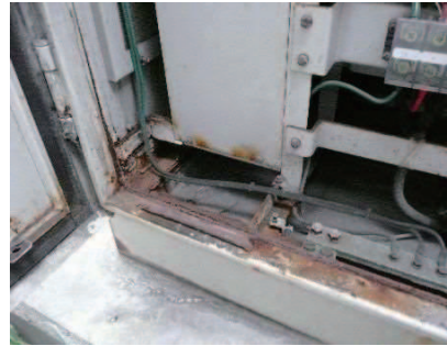
写真 1.2 箱体外部の腐食
