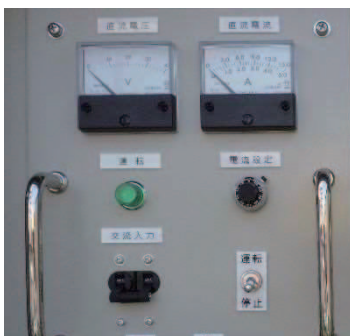
c) 扉内部にランプ・メータあり
