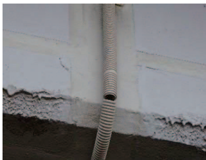
写真 1.7 配管材の割れ
