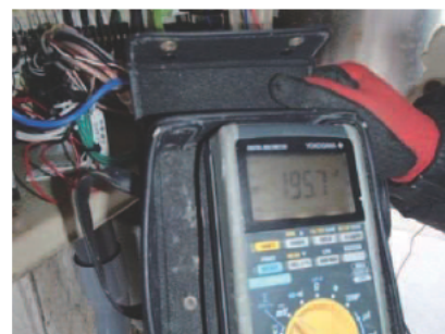
写真 4.2 電位値不安定（195.7mV）
