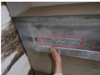
写真 3.1 被覆モルタル浮き部
