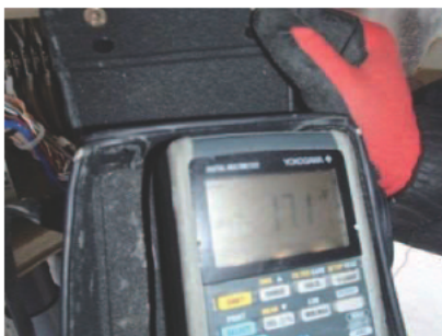
写真 4.1 電位値不安定（17.1mV）
