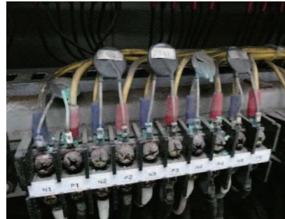
写真 1.6 端子の劣化・腐食
