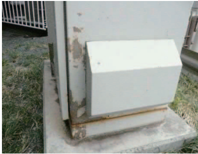
写真 1.1 箱体塗装の剥がれ
