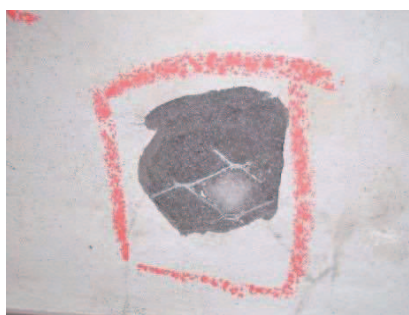
写真 1.12 被覆モルタルの剥落 (チタンメッシュ方式)
