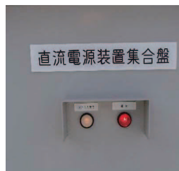
d) 受電ランプ(左), 運転ランプ(右)
