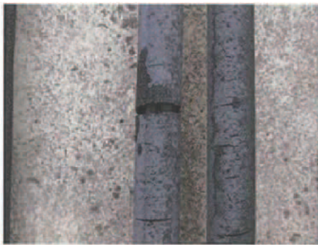
a)配線保護材の割れの例
