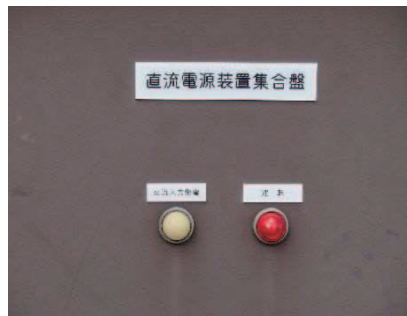
写真 1.4 受電/運転ランプの色褪せ
