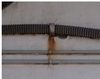
写真 1.9 配管固定金具からの錆汁
