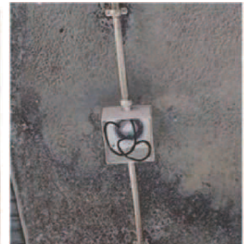
c)プルボックス蓋の脱落の例
