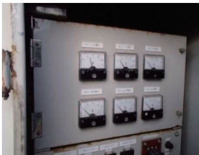
写真 1.3 箱体内部の腐食
