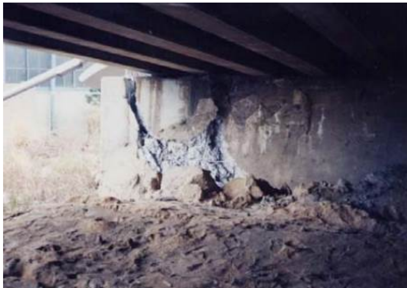
図-1.1.11 1995年1月17日兵庫県南部地震で下部構造が傾斜し損傷した東魚崎大橋 9)
