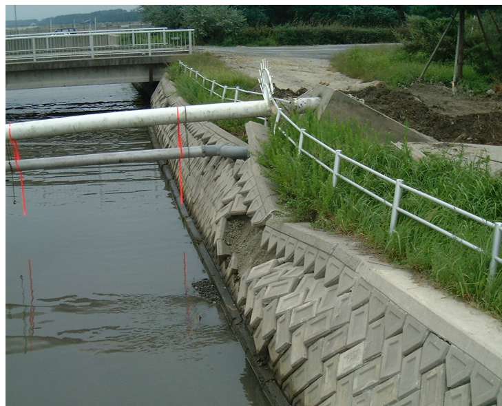
図-6.1.13 流動による護岸の変状
