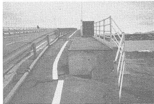
写真-13・20 十三湖大橋の橋台裏込め土の沈下(A,橋台)
