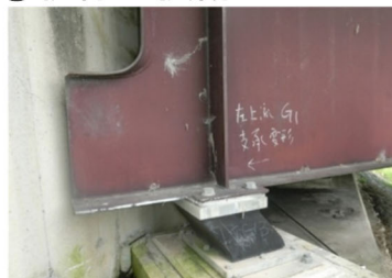
③ 支承部の損傷
