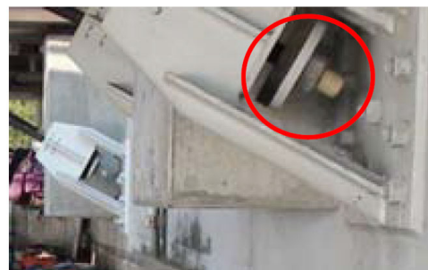
図-6.1.20 落橋防止構造のケーブル端部の緩み
