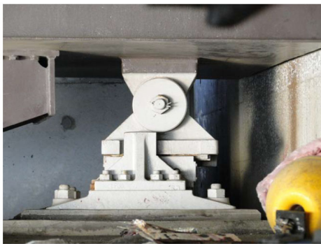
図-6.1.19 可動支承に生じた変状
