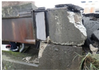
⑤ パラペットの損傷
