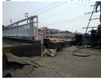
⑥ 背面盛土の沈下
