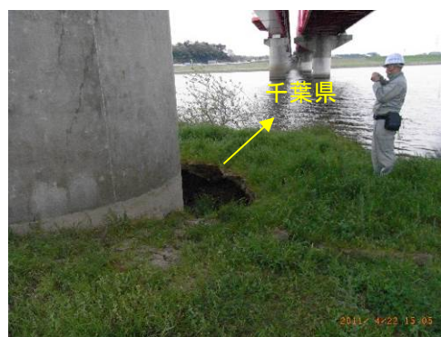
(d) P 6 橋脚躯体と周辺地盤間の隙間
