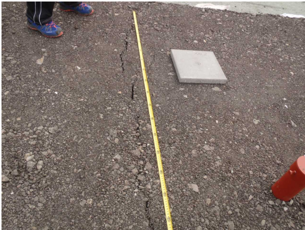
写真-1 盛土天端のひび割れ発生状況の例 (札幌施工区)
