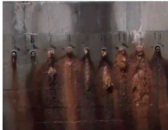
集水管の状況（閉塞）
