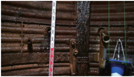
集水管の閉塞状況（深さ 11m）
