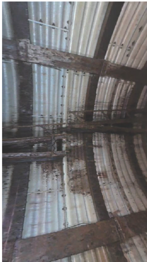
昇降階段の破損状況 (笹山地すべり防止区域：新潟県土木部提供)
