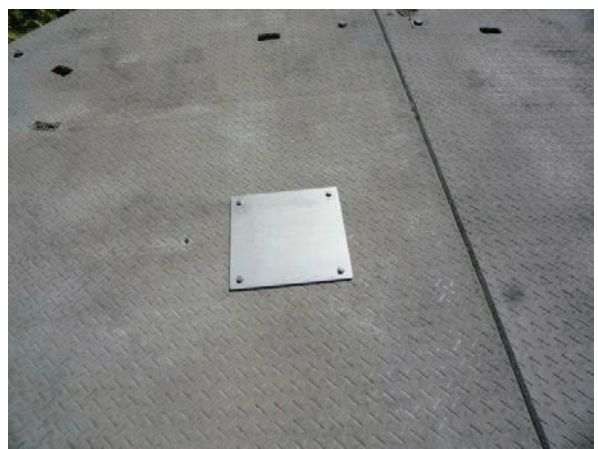
図13 カメラ点検用に設けられた点検孔 (新潟県) (カメラの挿入時は点検孔の蓋を取り外す)
