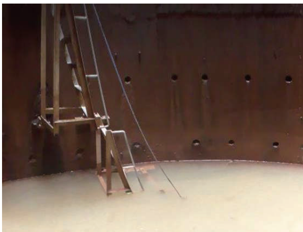
排水管の状況（湛水）
