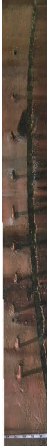
集水ボーリング状況および集水井本体の破損状況（水沢新田地すべり防止区域：新潟県土木部提供）
