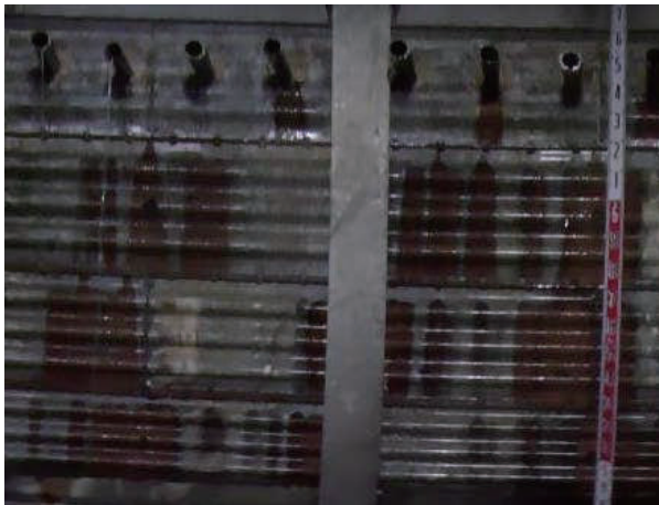
壁材の状況（発錆）
