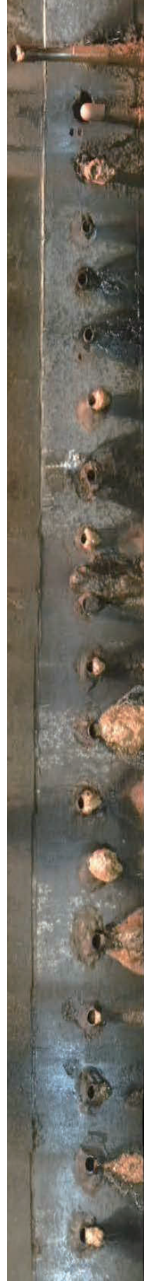
集水ボーリングの閉塞状況 (蓬平地すべり防止区域：新潟県土木部提供)
