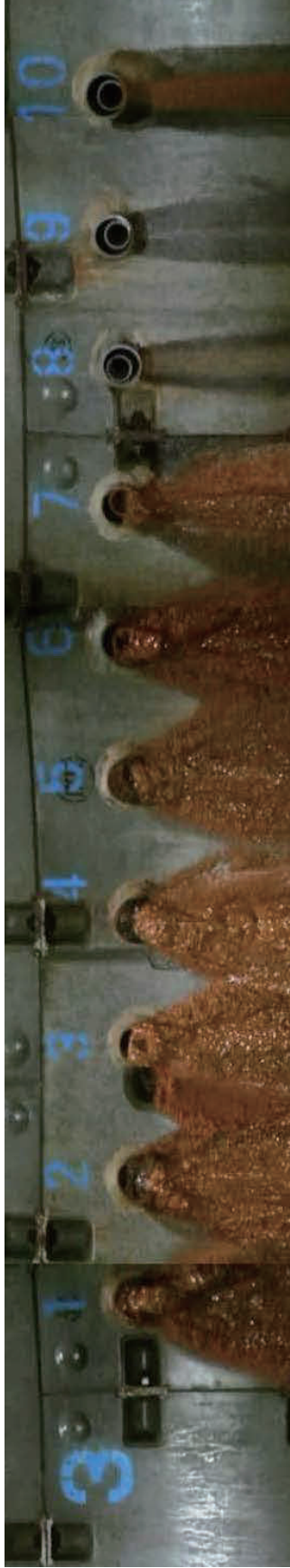
集水ボーリングの閉塞状況 (田麦山小高地すべり防止区域：新潟県土木部提供)
