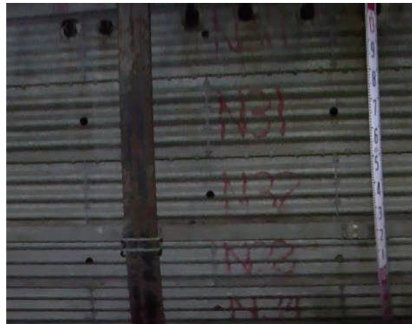
バーティカルスティフナーの状況（発錆）
