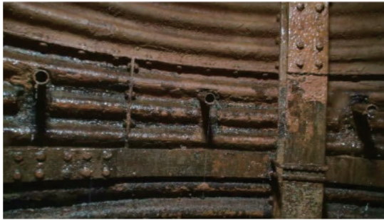
集水管の閉塞状況（深さ 12.5m）
