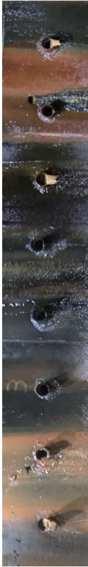
集水ボーリング状況（入塩川地すべり防止区域：新潟県土木部提供）
