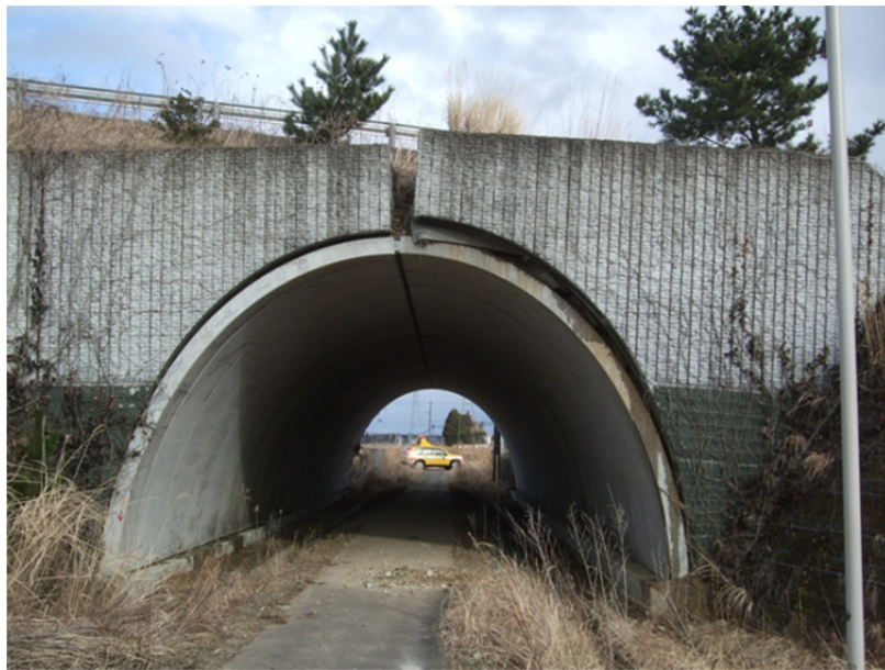
(b) 坑口壁の変形
