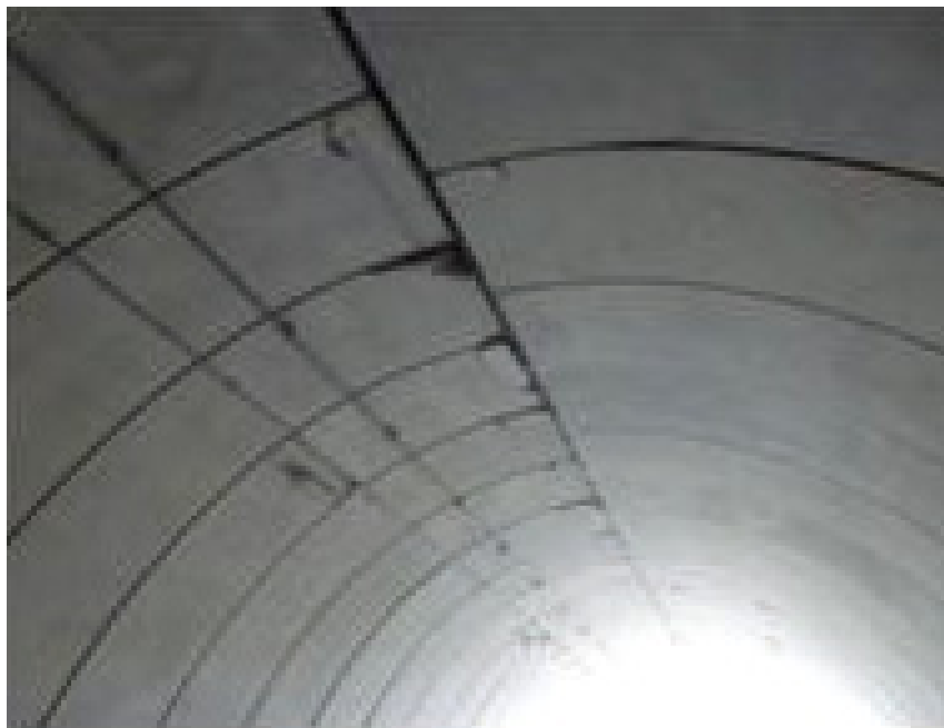
写真-4.1.1 アーチ天井部のコンクリート片の剥落[参考文献2より転載]
