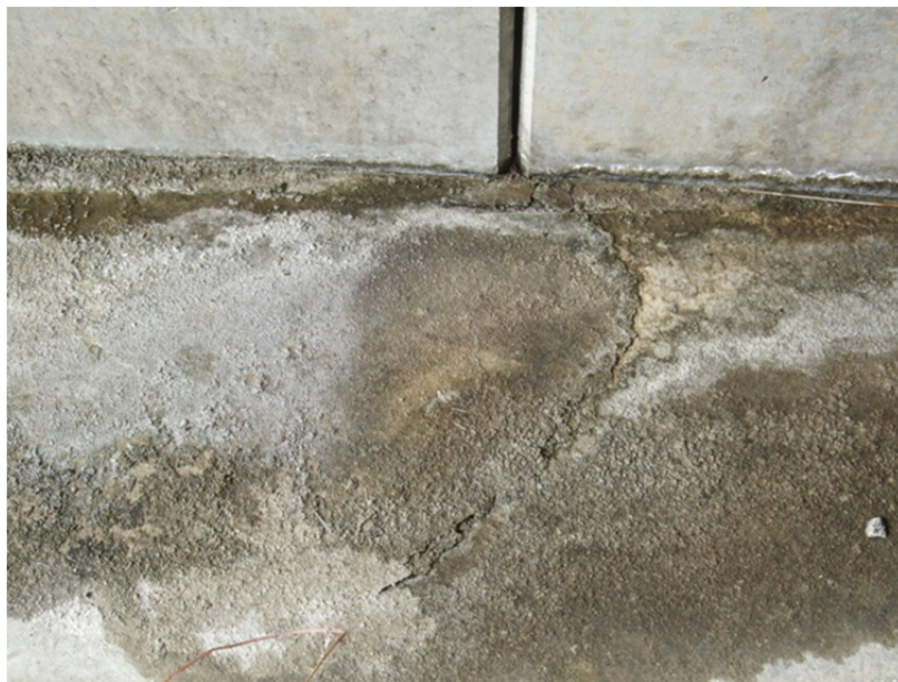
(b) 基礎部材のひび割れ
