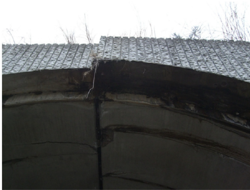
(a) 坑口壁のはらみだし
