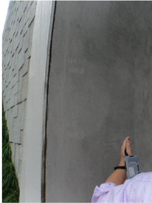
写真-2.13 軸方向鉄筋位置でのクラック
