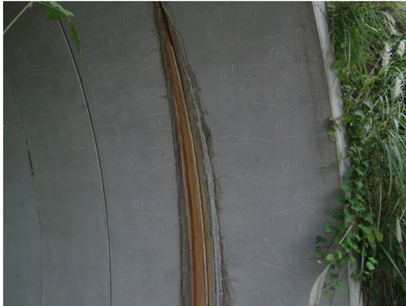
(a) 部材接合部の漏水
