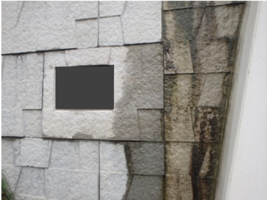
写真-2.14 面壁からの漏水状況
