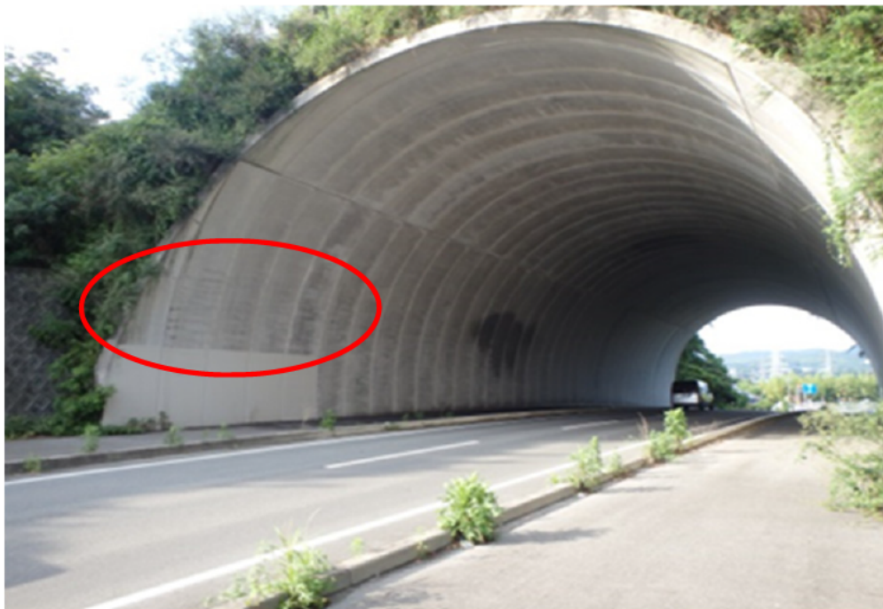
写真-2.7 側壁の曲げクラック（赤丸箇所）
