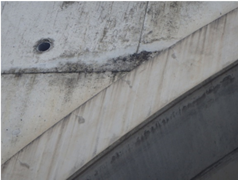
写真-2.17 アーチ外側の曲げひび割れ
