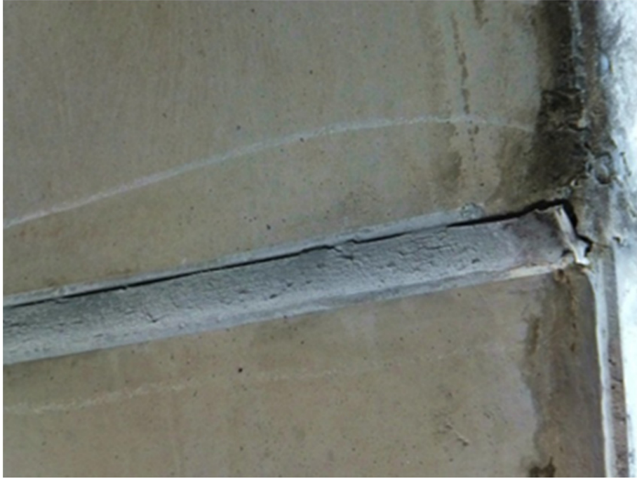
写真-2.4 目地材の劣化
