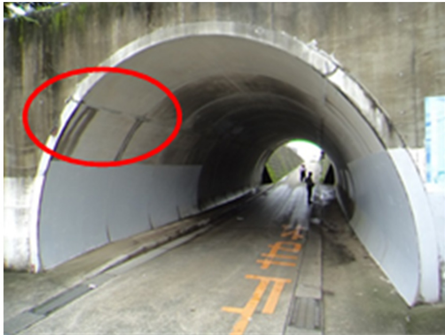
写真-2.5 目地の劣化による漏水跡
