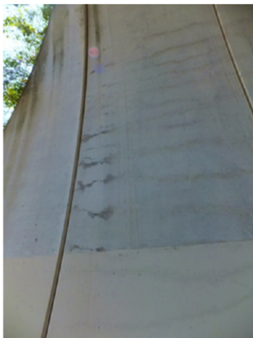
写真-2.8 側壁の曲げクラック
