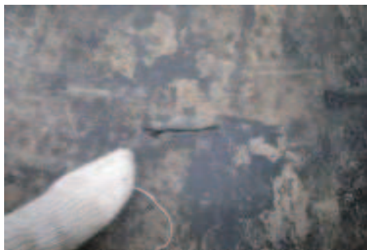
写真 2.1.6 流下物による損傷状態
