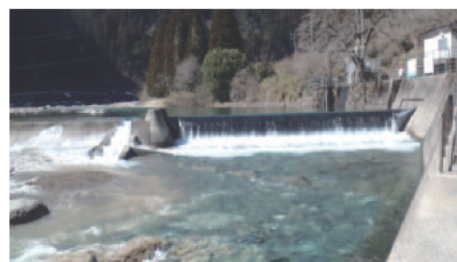
写真 2.1.25 ゴム袋体全景
