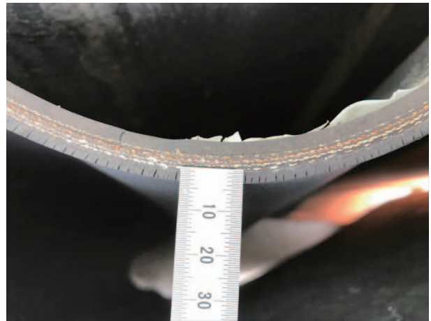
写真 2.2.21 深さ方向に進行したひび割れ
