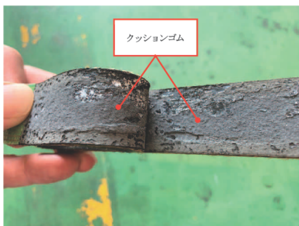
写真 3.2.17 凝集破壊の例
