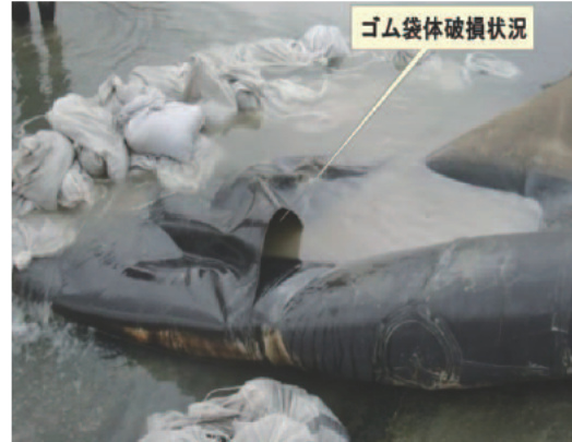
写真 2.1.3 接合部のはく離
