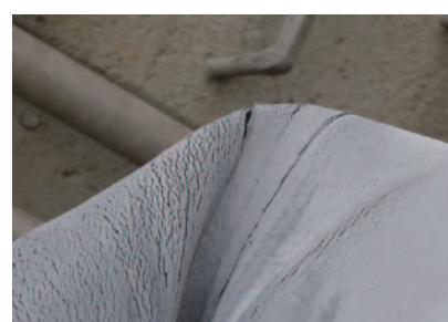
写真2.1.21 ゴムの劣化亀裂(法部)
