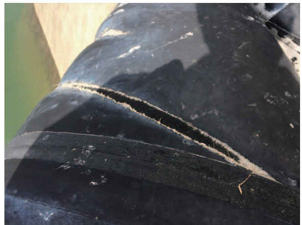
写真 2.2.23 織布破断したゴム袋体
