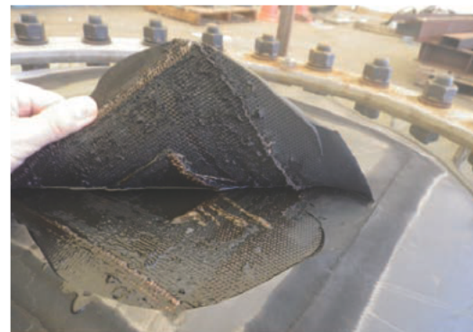
写真 3.2.20 補修部剥がれの状態
