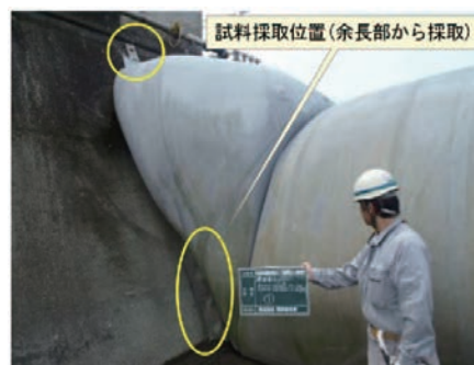
写真 2.2.12 試料採取位置(両岸法部2箇所)
