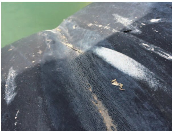
写真 2.2.22 カバーゴムのオゾンによるひび割れ
