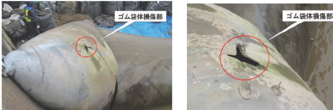
写真 2.1.9 コンクリート躯体との擦れによる摩耗損傷（右写真：拡大図）
