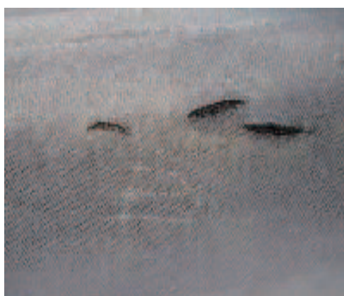
写真 2.1.7 バックホウの爪による損傷
