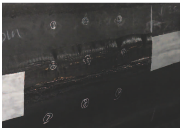
写真 3.1.6 内部側面内面はく離部外観
