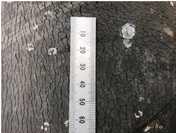
写真 2.2.20 カバーゴムのオゾンによるひび割れ
