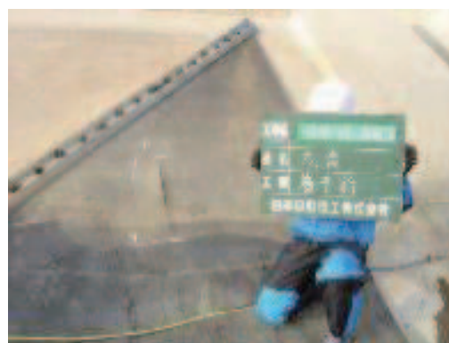
写真 2.1.8 カッターナイフによる悪戯での損傷
