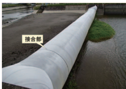
写真2.1.19 ゴム袋体全景
