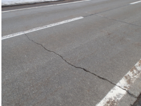
写真-4.3.1 横断ひび割れ
