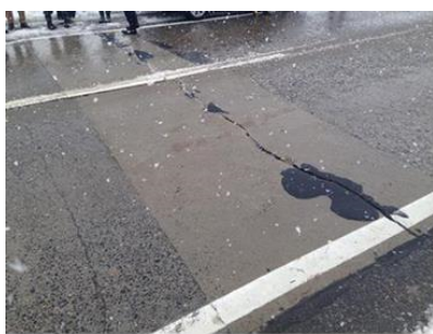
写真-1.1.1 目地部を跨いだ補修事例（後ににひび割れが発生）
