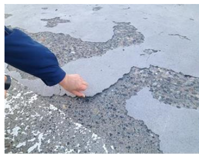
写真-1.1.2 浮きの生じた樹脂系補修材
