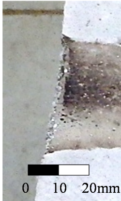
写真-5.3.1 目地部に生じた欠け(PCM-c)
