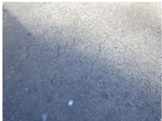
写真-4.3.8 ひび割れ発生状況
