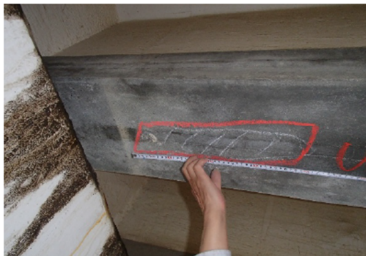
写真-3.3.3 G5桁被覆モルタル浮き部
