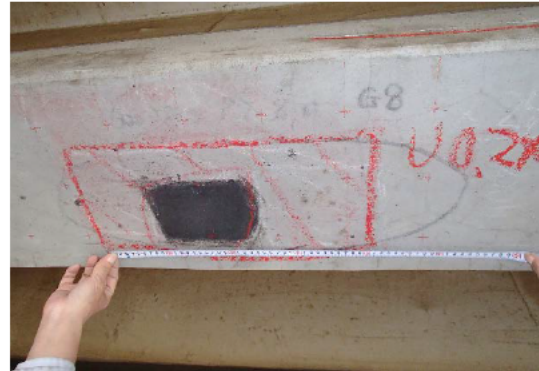
写真-3.3.2 G4桁被覆モルタル剥落部
