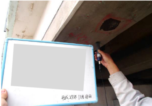
写真-3.3.21 チタンメッシュG1桁剥落部測定状況
