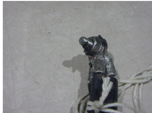
写真-5.5.5.8 結線部詳細 G10-4 回路
