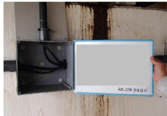
写真-3.3.18 橋脚部プルボックス
