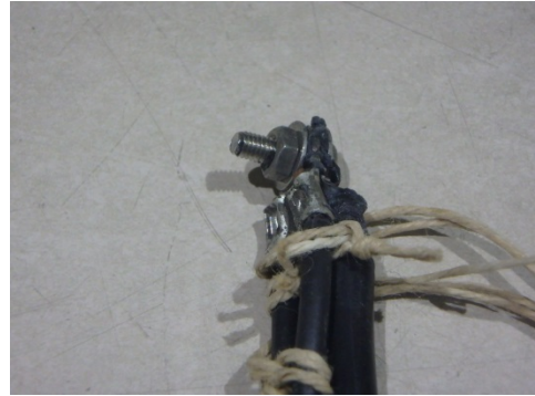
写真-5.5.5.6 結線部詳細 G11-3 回路
