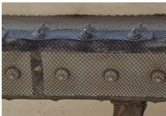
写真-3.3.5 流電防食板波打ち状況
