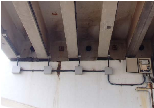
写真-3.3.23 チタンメッシュ方式 配線分配状況（P7橋脚側面）
