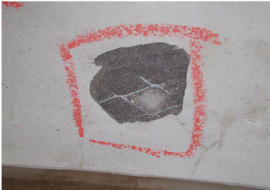
写真-3.3.1 G1桁被覆モルタル剥落部
