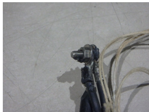
写真-5.5.5.10 結線部詳細 G11-4 回路
