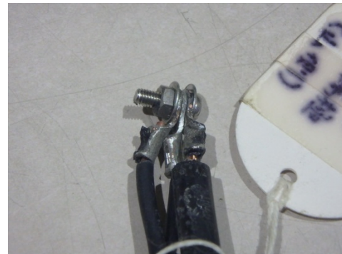
写真-5.5.5.4 結線部詳細 G10-3 回路
