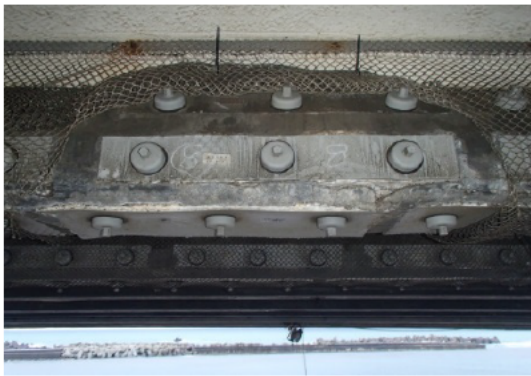
写真-4.5.1 既設防食板（亜鉛シート）
