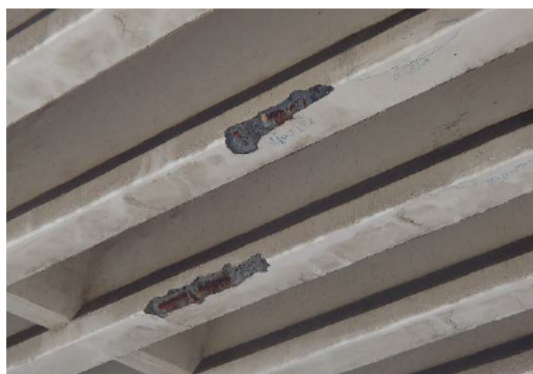
写真-2.5.4 主桁の変状（他径間）
