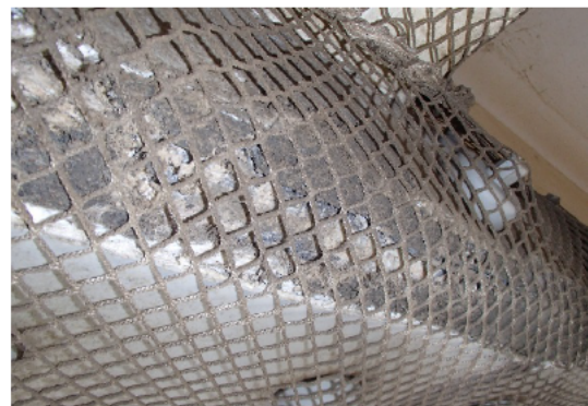
写真-3.3.4 G9桁パテ剥落部
