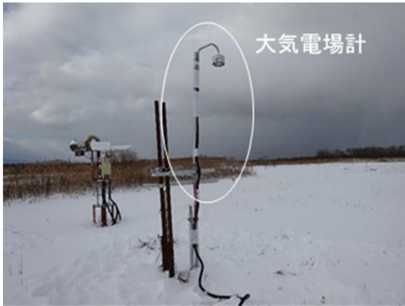
図-1 大気電場計の設置状況
