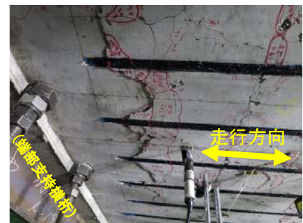
写真-3 破壊状況(軸方向端部)
