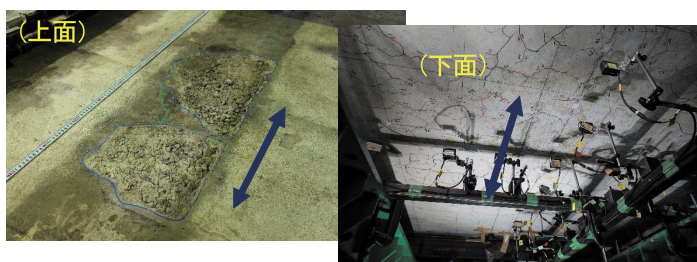
写真-4 土砂化発生での床版の状況
