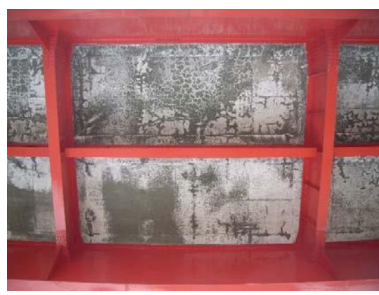
写真-1 ASR によるひびわれ損傷が生じた床版
