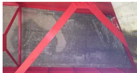
写真-2 床版下面の湿潤状態
