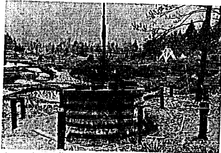
鋼杭が浮き上り傾斜した (山側より写す)
