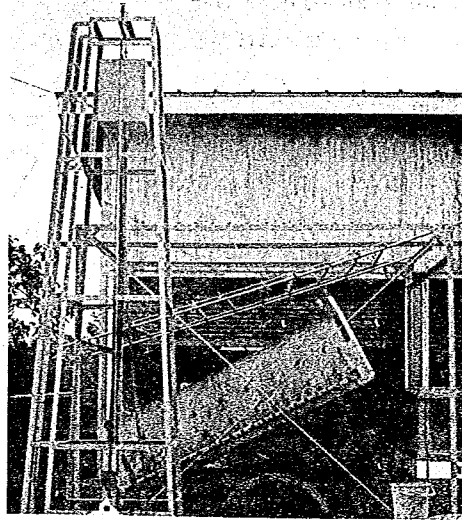
写真-5.3 装置の全景
