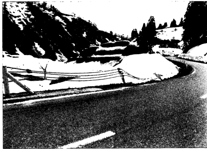
写真 5 - 2 雪圧により転倒したガードケーブル ( B 種 )
