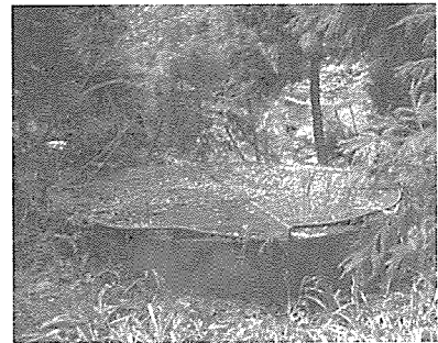
写真－３ 天蓋の変形
