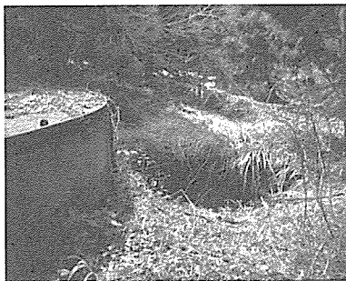
写真－１ 集水井周辺の陥没
