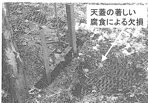
写真-1.7 集水井天蓋の著しい腐食事例
