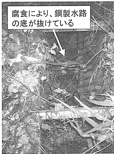
写真-1.9 鋼製水路の腐食による破損事例
