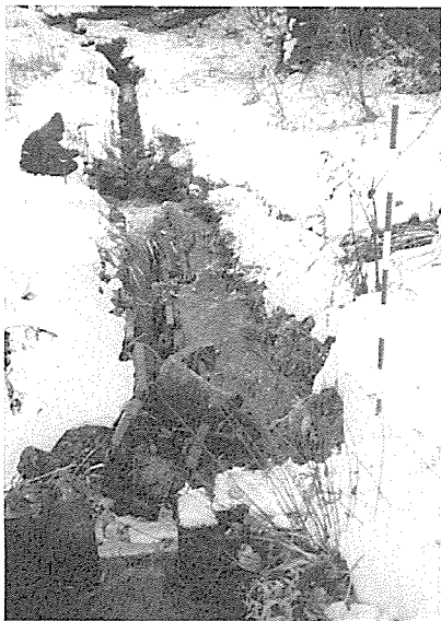
写真-1.5 水路の破損事例
