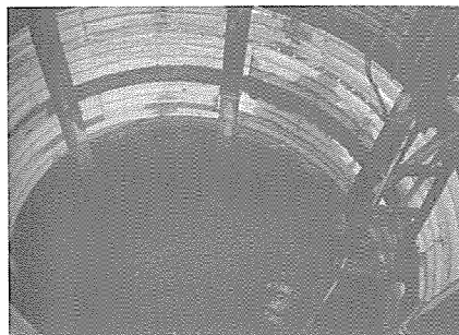
写真－５ 集水井の異常な湛水
