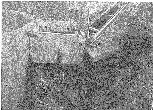
写真-1.6 集水ます変形と基礎の流出事例
