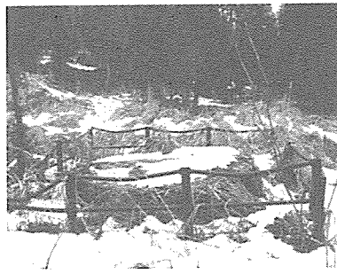
写真－２ 保護柵の破損変形
