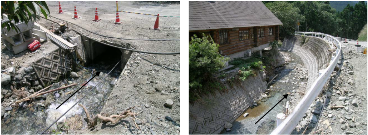
図 4.2.8 早楠川（津留川右支川）の状況 (※2007/7/27 撮影)
