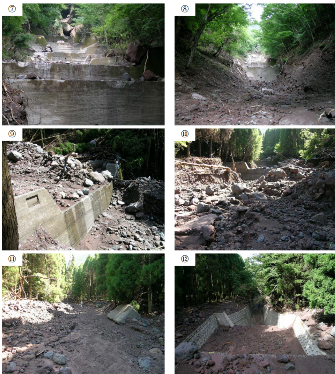
図 4.5.3 湯の坪川の土石流発生区間の状況 (※2007.8.14 撮影)
