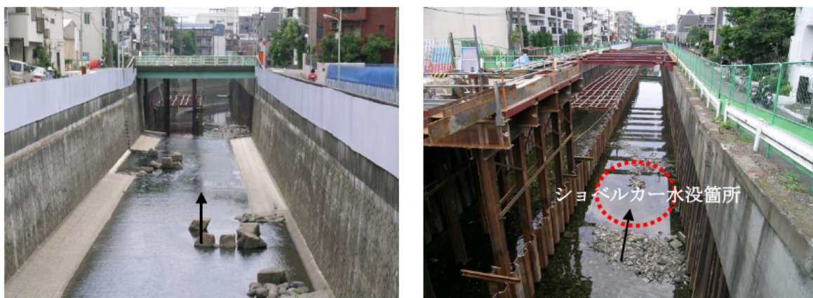
図 2.9.1 災害発生地点の河道状況 (※08.07.11 撮影)
