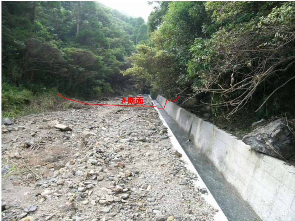
図 3.4.7 A断面（滝下流部）における氾濫状況
