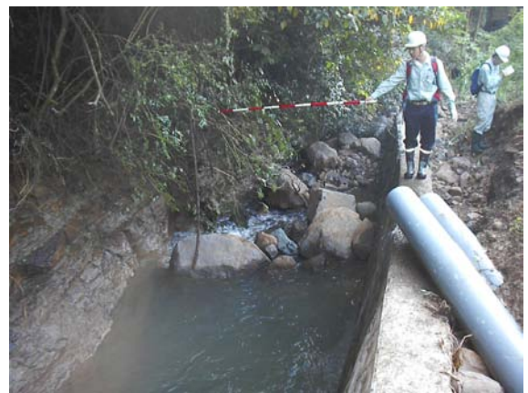
図 3.3.5 左図の上流側の閉塞状況
