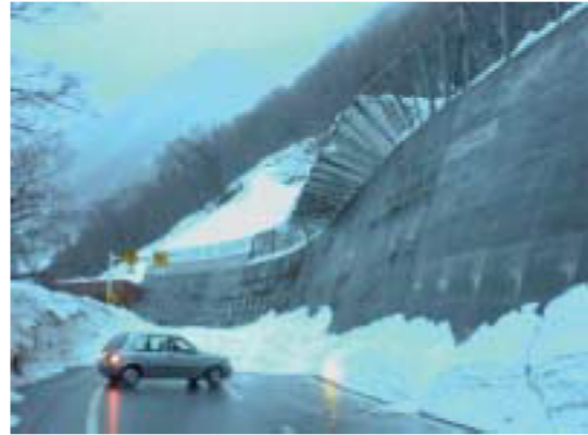
写真 3-28 防護擁壁上の柵の破損
