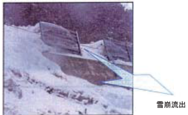
写真 3-30 雪崩防護擁壁を乗り越えそうな状況 1)
