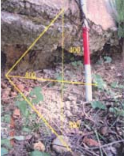
写真 3-6 基礎部の破損, 侵食 1)
