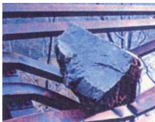
写真 3-5 落石による予防柵の破損、腐食 2)
