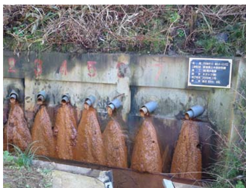
写真－７ 閉塞物が付着した集水管
