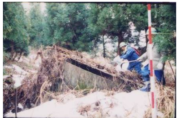
写真－9 傾いた集水井
