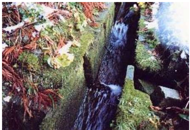
写真2 水路の接合部の目地が取れた水路
