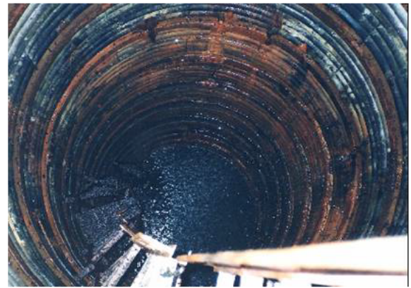
写真-13 ライナープレート製の集水井の腐食
