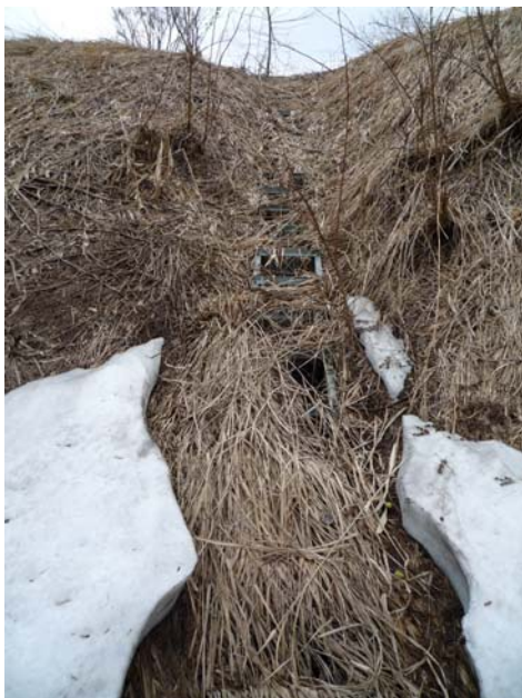
写真1 草が水路内に倒れ込んだ水路
