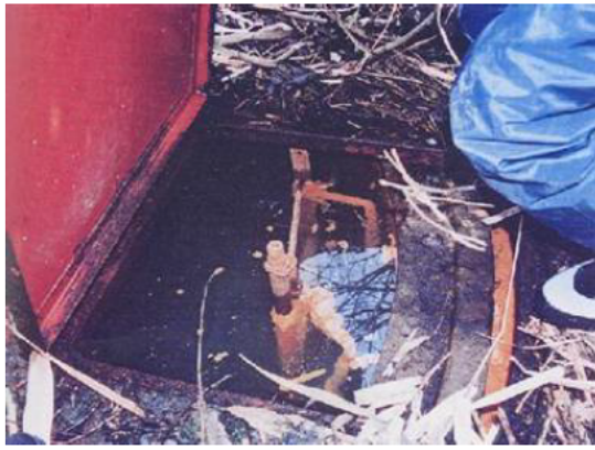
写真-12 排水管の破損により湛水した集水井
