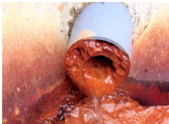
写真-17 閉塞した集水管A
