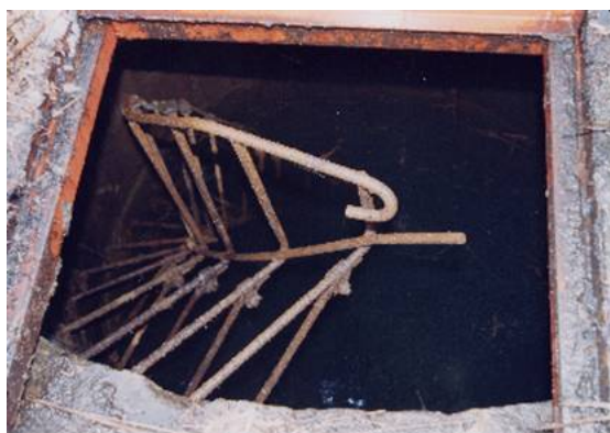
写真－10 集水井内に入るためのタラップの腐食
