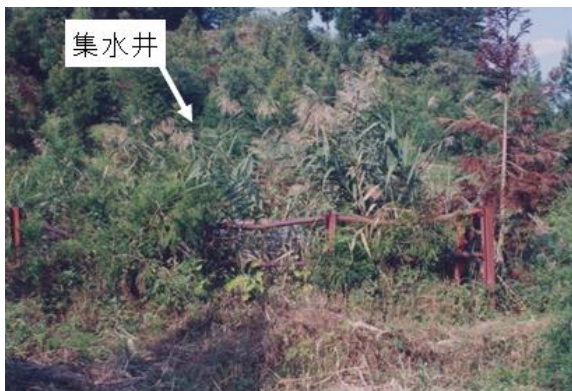
写真－8 草木で覆われた集水井
