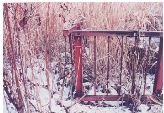
写真－11 破損した柵
