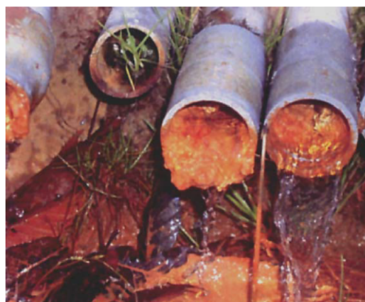
写真-15 閉塞した横ボーリング
