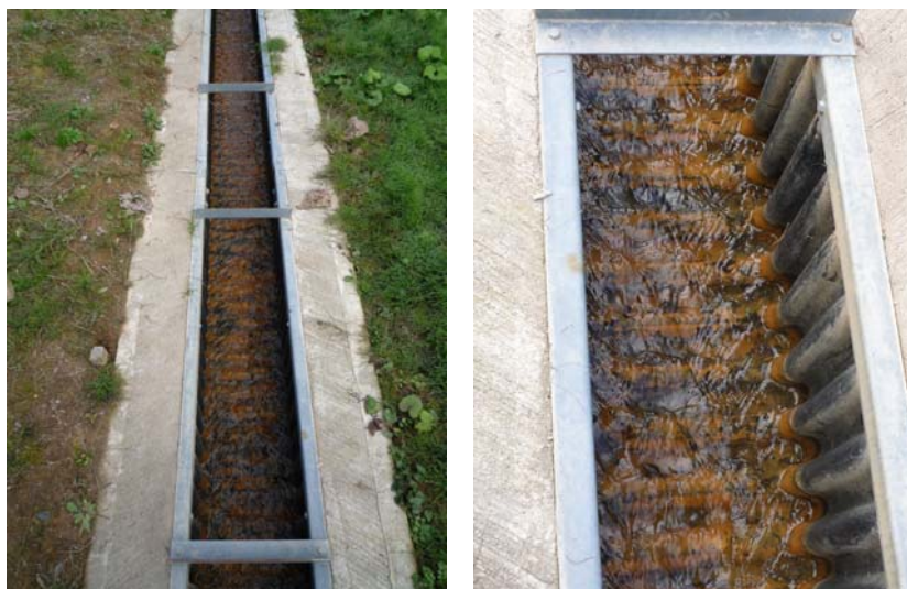
写真-27 樹脂製の水路
