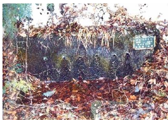
写真－６ 木の葉等が堆積した集水マス
