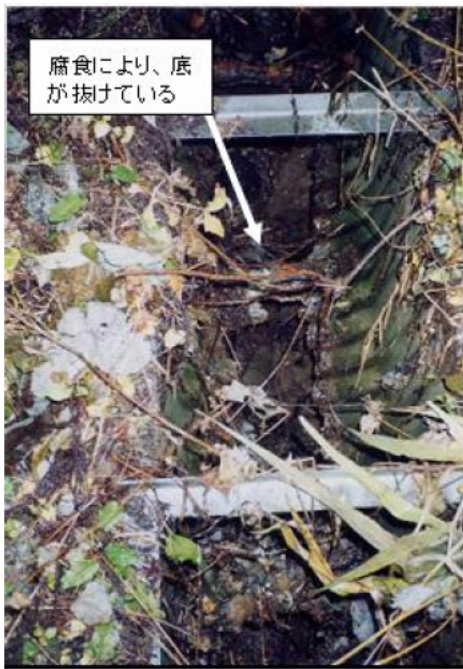
写真-3 腐食により底が抜けた鋼製
