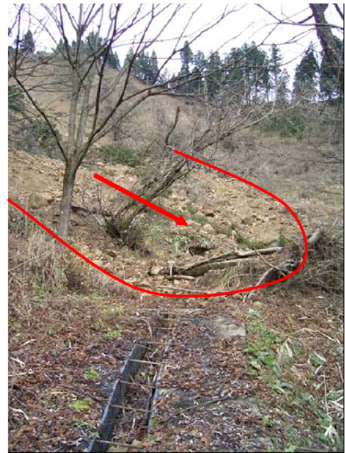
写真-4 小崩壊による土砂に埋まった水路
