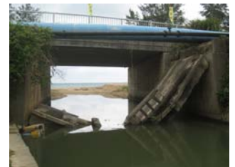
写真-1 落橋事例
