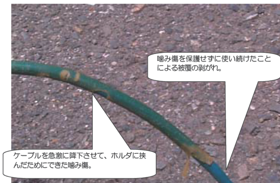
写真4-9 ケーブルの破損状況の例
