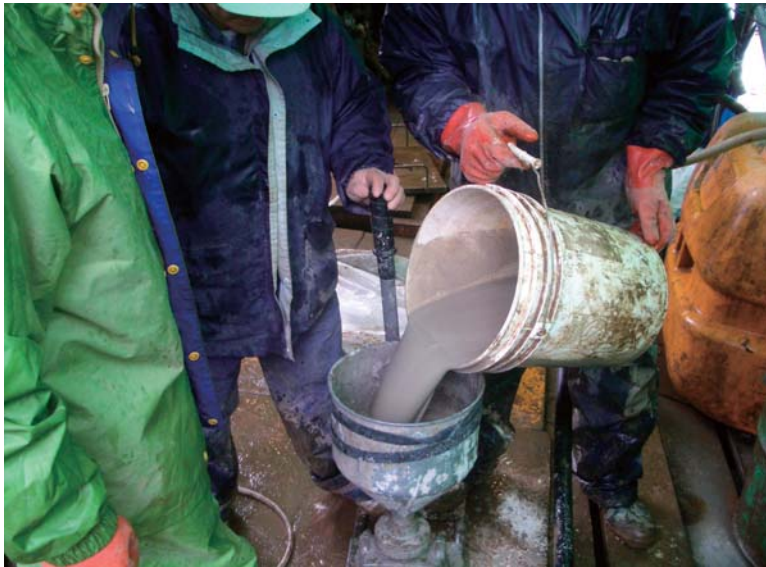
写真3-28 充填作業の状況の例 手押しポンプを使用 水100L, セメント2袋(50kg), 粘土2袋(50kg) 出来上がり量120L程度
