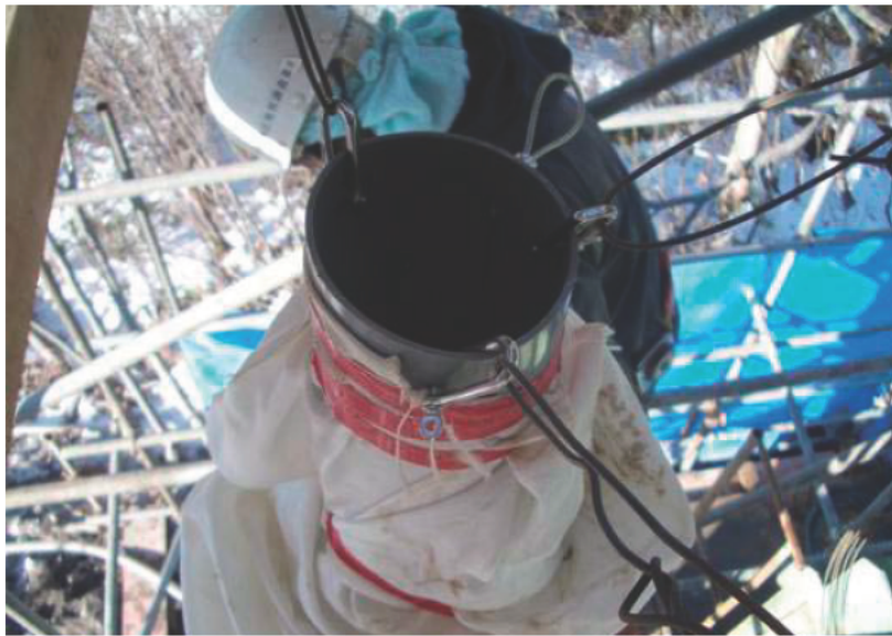
写真3-24 塩ビ管の吊るし部の例
