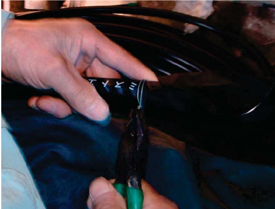
写真3-20 丸形ホースとの接続
