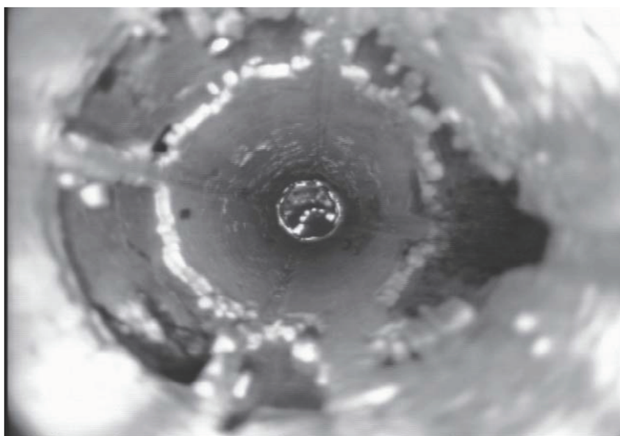
写真4-2 ガイド管破損例（カメラ観察による）
