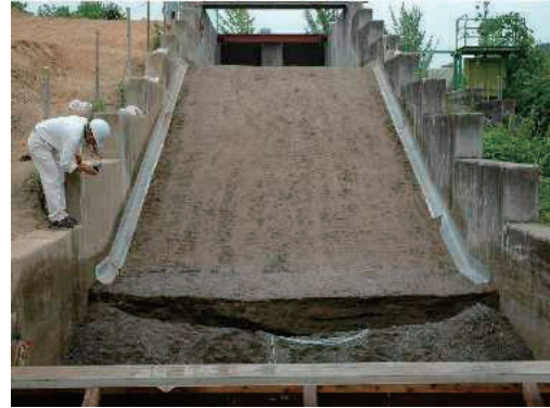
写真-3.42 越水120分後
