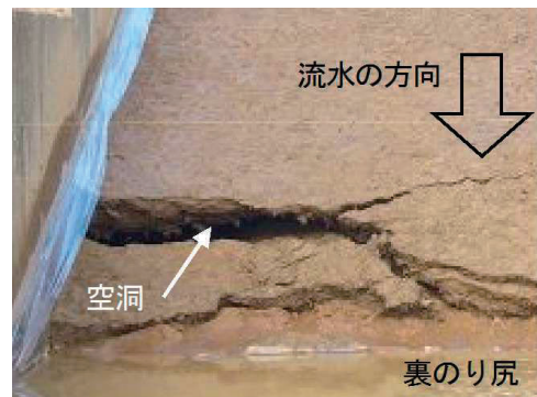
写真-3.28 補強土の下面の空洞 (越水120分後)
