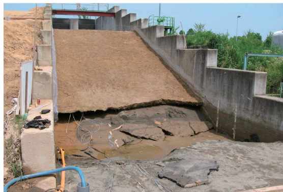
写真-3.20 流出したアスファルト
