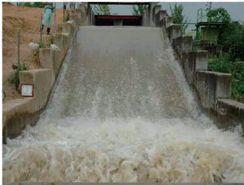
写真-3.41 越水90分後
