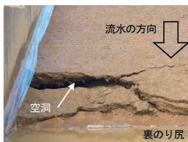
写真-8 保護工下の空洞
