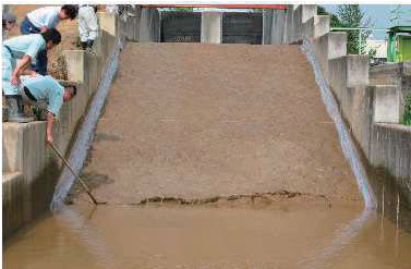
写真-4 越水90分後
