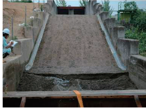
写真-3.44 越水180分後
