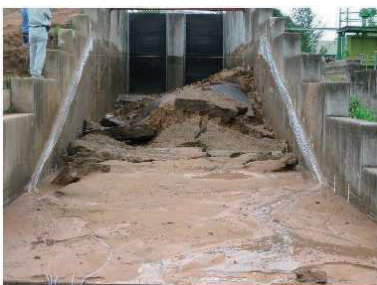
写真-7 越水133分後
