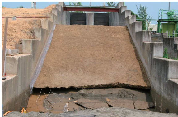
写真-3.19 越水9分後
