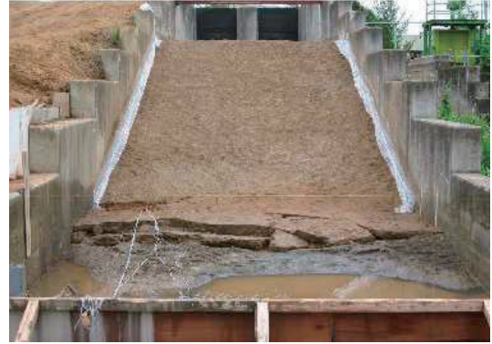
写真-3.23 越水30分後
