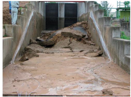
写真-3.37 越水132分後
