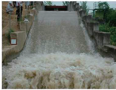
写真-3.39 越水30分後
