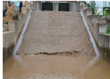
写真-2 越水30分後
