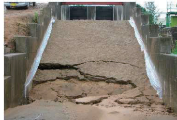
写真-5 越水120分後
