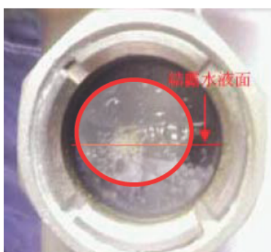
写真-15 配管結露状況
