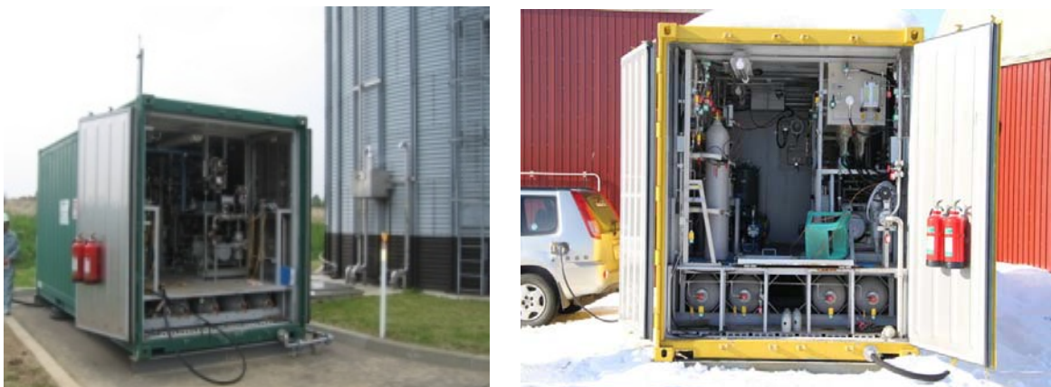
写真－12 バイオガス精製圧縮充填装置
