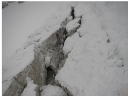
塩化ビニール管の破碎
