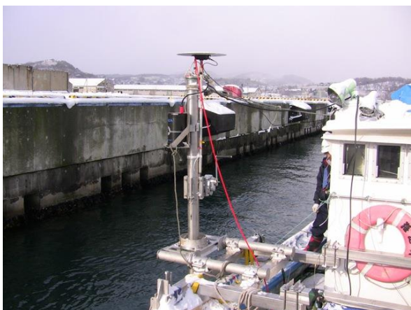
計測機器類（水上部）
