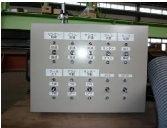
第1回試験 制御盤
