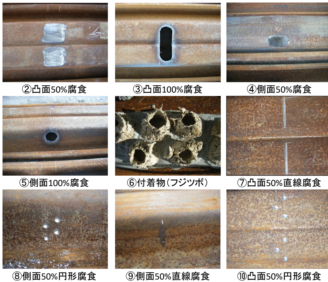
図-28 模擬腐食等の形態
