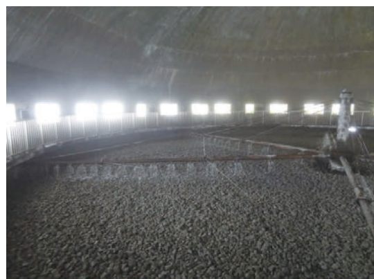
散水ろ床外観内部(吹き出し口の配置は外側が密になっている)
