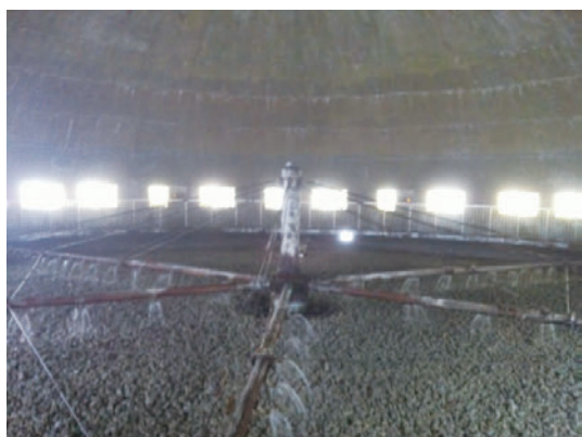
散水ろ床外観内部(アーム 6 本, 約 4.5 分でアームが 1 周する)
