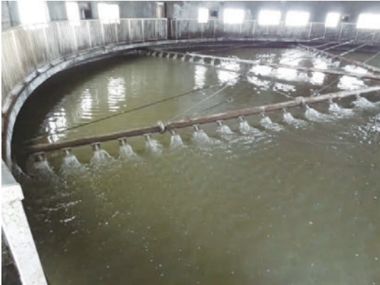
通水により湛水の水面がやや低下したろ床の状態
