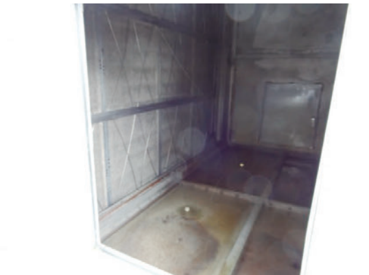
排風機内部（換気とともにろ床バエがトラップされる）
