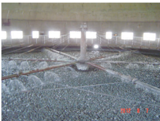
散水ろ床内部(アーム 6 本)
