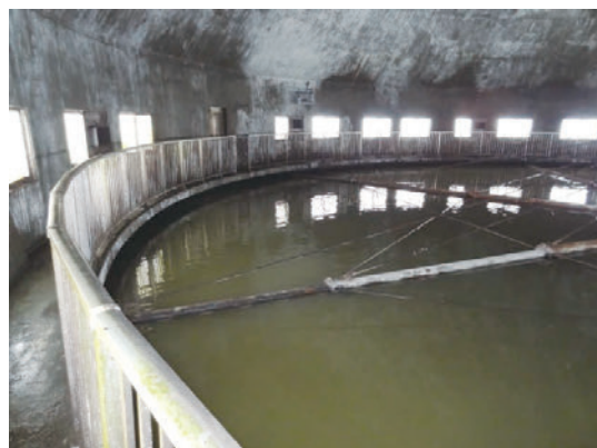
散水ろ床の湛水時の状況(満水後は、湛水用の通水口から排水される)
