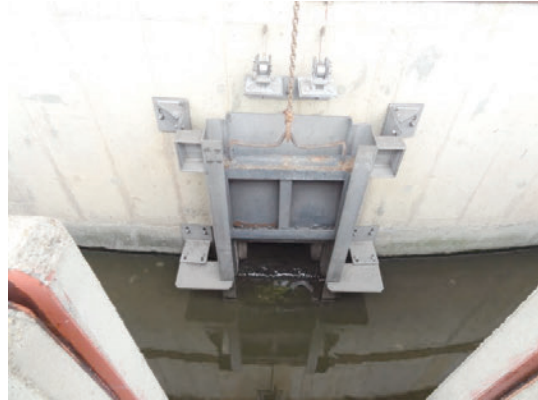
解放された通水口のゲート
