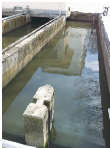
塩素消毒槽(塩素注入量は 2.5mg/L 程度)
