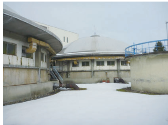
散水ろ床外観近景(ダクトは排風機に接続されている)
