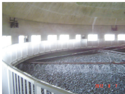
散水ろ床内部(吹き出し口の配置は外側が密になっている)
