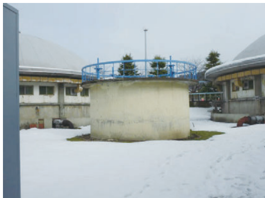
重力濃縮槽の分水槽
