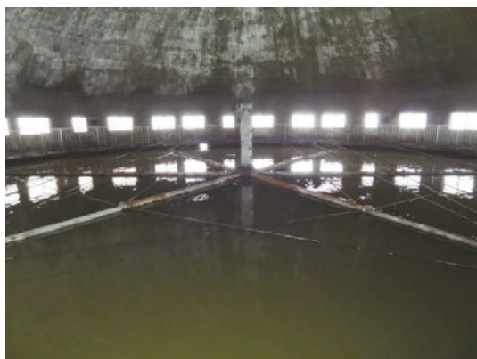
散水ろ床の湛水時の状況(一次処理水を一日程度貯留する、月1回程度行っている)
