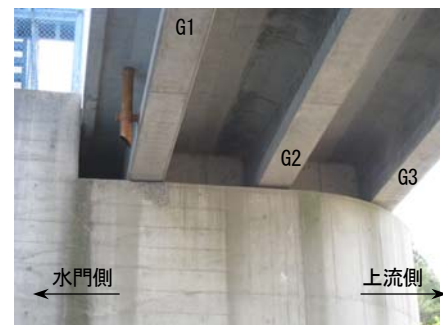
写真-3 橋座部の損傷状況（第 3 径間）
