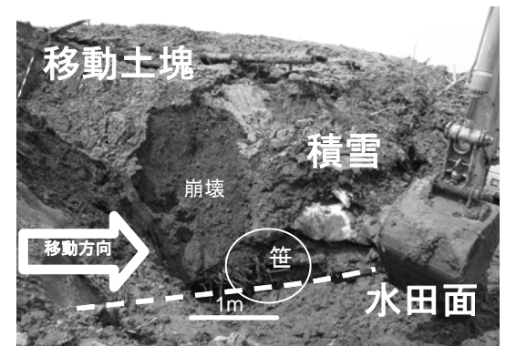
写真-2 掘削状況(トレンチ No. 2) 移動土塊は掘削中に崩壊を繰り返し、極めて軟質かつ緩んでいる
