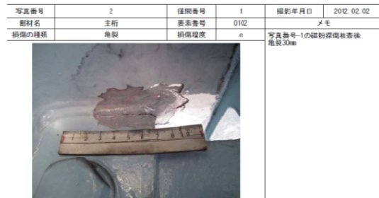
図-6 主桁 G1 垂直補剛材上端のき裂
