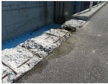
(a) 地覆部の圧壊
