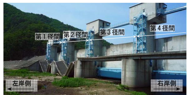
写真-1 橋梁全景 (被災直後)
