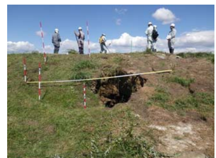
写真 3.2.1 裏のり肩付近の陥没（東北地方整備局提供）
