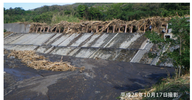
写真-7 流木の捕捉状況
