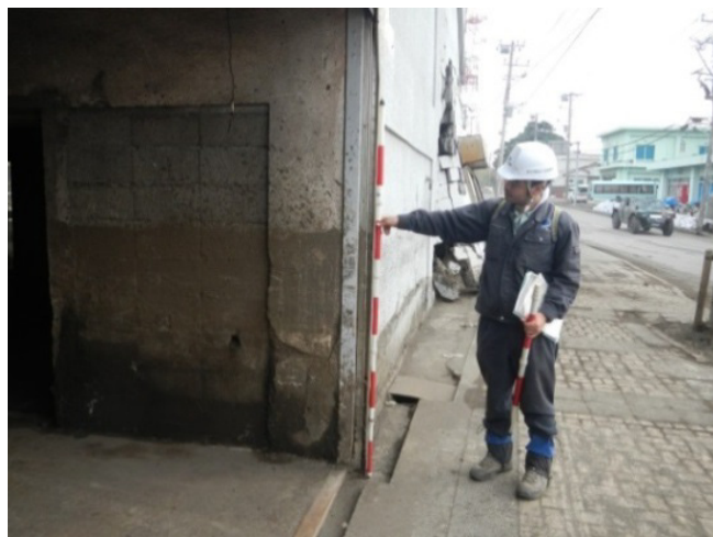
写真-2 建物の痕跡の例
