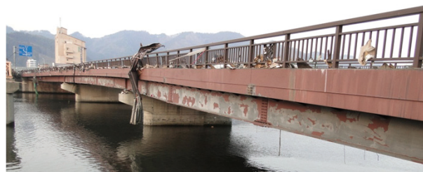
写真-4 上部構造が流出しなかった橋
