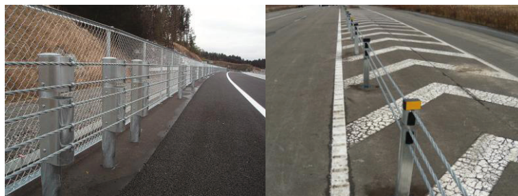
写真-3 ガードケーブル(左)とワイヤーロープ式防護柵(右)
