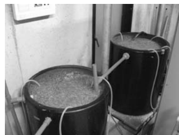
写真-4 担体処理反応槽
