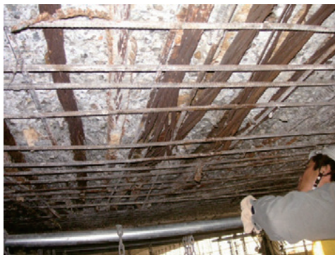
図-1 PC鋼材の腐食・破断
