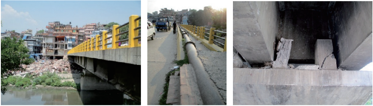
写真-5 Bishmati 川を渡る橋梁の被害（隣接 RC 建物の被害、水管、支承部のストッパーの損傷）
