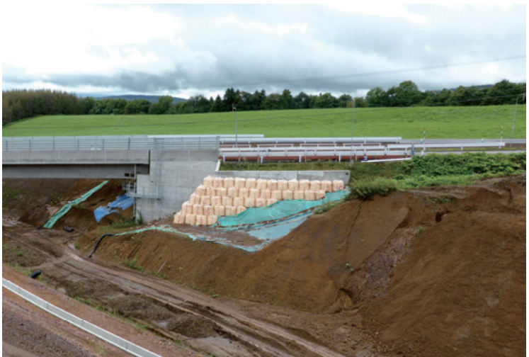
図-21 盛土内部構造調査を適用した盛土変状発生箇所の外観
