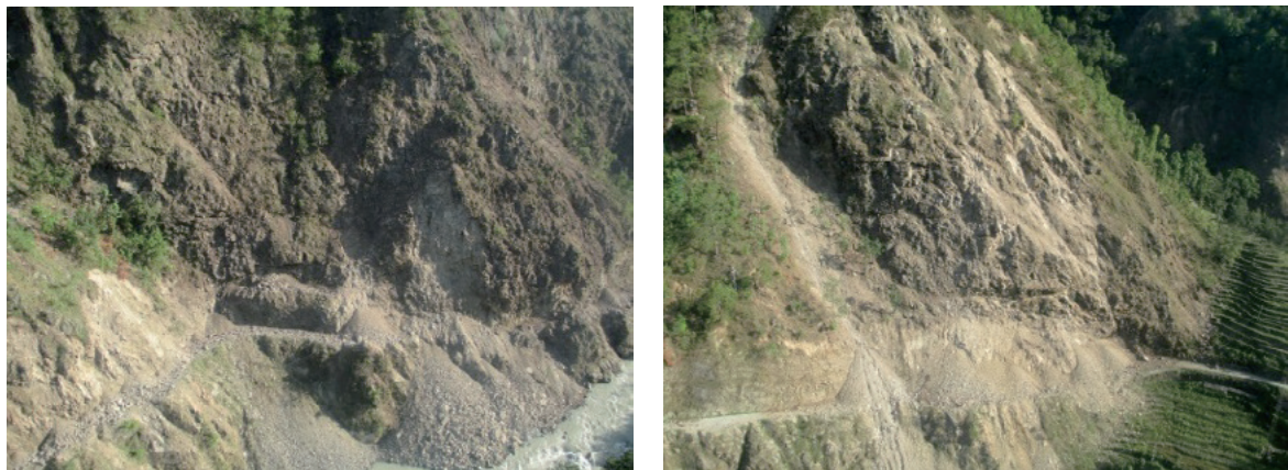
写真-7 シンガチ地区の道路の斜面崩壊
