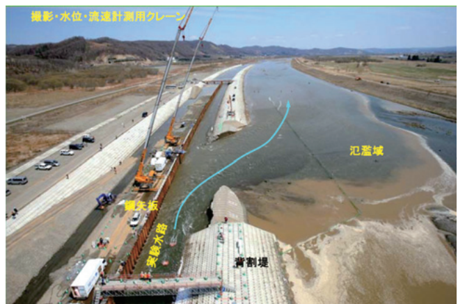
図-2 千代田実験水路の全体風景
