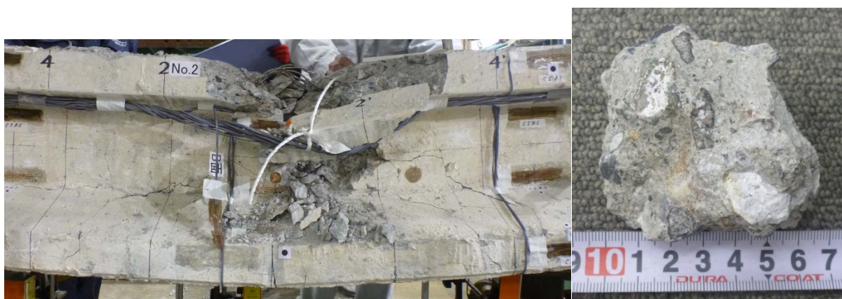
写真-5.3 コンクリート片 (G3 桁)
