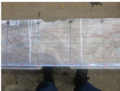
写真-3 ひび割れの状況
