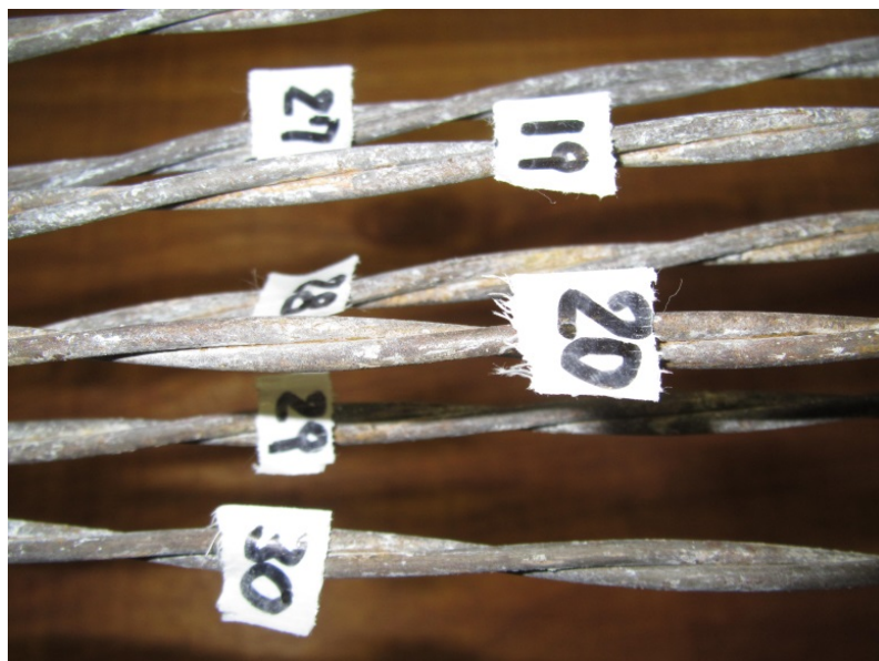
写真- 4.3 G3 桁下フランジ鋼材状況（詳細）
