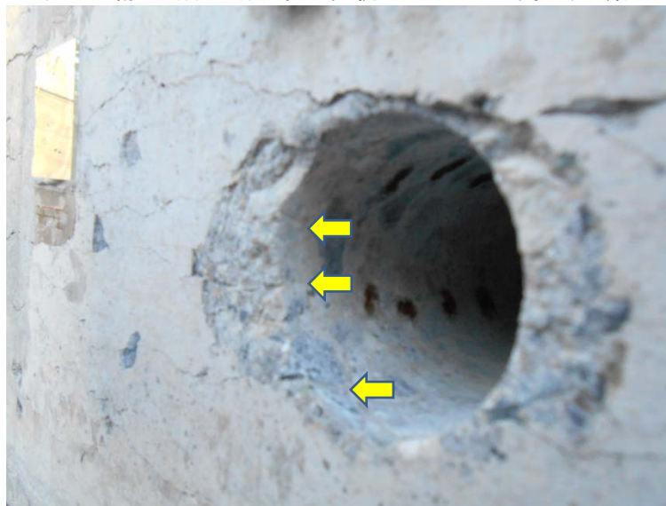
d) 28' コア削孔内面 (矢印：目視によるひび割れ先端)
