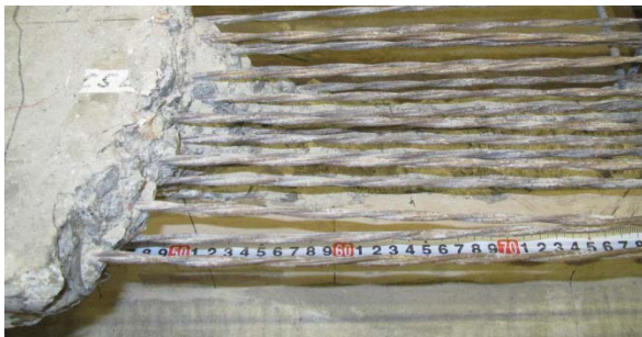
a) G6 桁 6' 断面付近（はつり調査）
