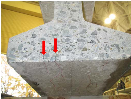
桁下面のひび割れ深さは約 6~7mm で、骨材を貫通するひび割れが認められた。 a-1) ひび割れ深さ
