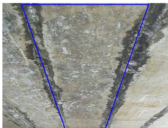
(b) G6 桁下面の損傷写真
