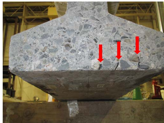
桁下面のひび割れ深さは約 10~19mm で、骨材にそったひび割れが認められた。 b-1) ひび割れ深さ
