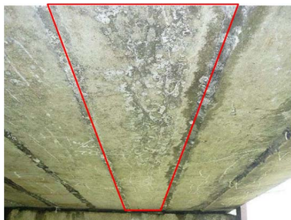
(b) G3 桁下面の損傷写真
