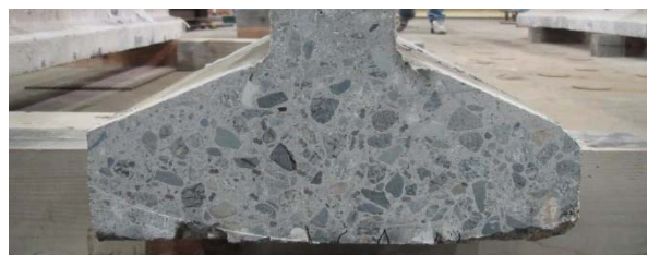
d) G3 桁 22' 桁切断面（下フランジ）
