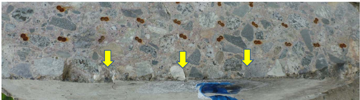
c) 22' 桁切断面 (矢印：目視によるひび割れ先端)
