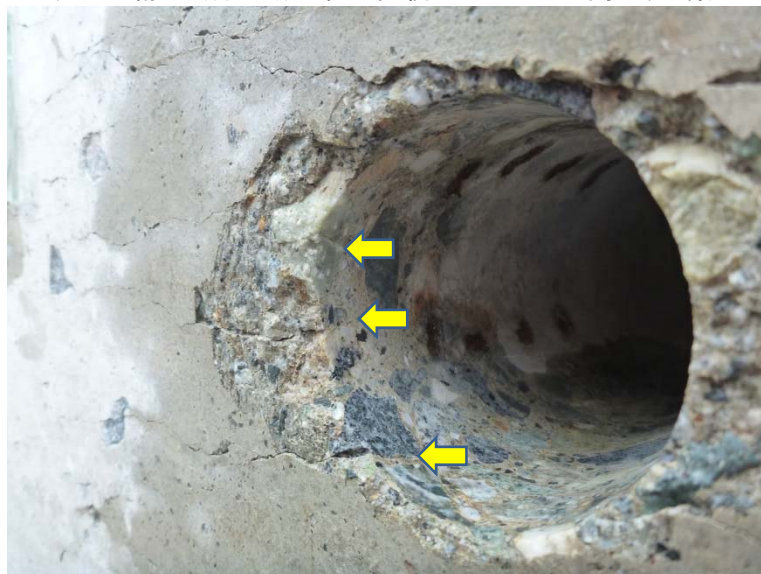
d) 28' コア削孔内面 (矢印：目視によるひび割れ先端)
