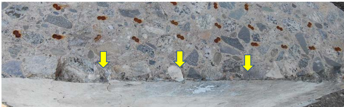
c) 22' 桁切断面 (矢印：目視によるひび割れ先端)
