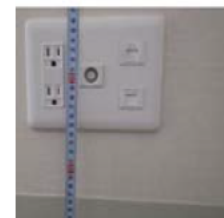
รูเสียบของช่องต่อสัญญาณหลัก (Modular jack) กับเตี้ยเสียบไฟฟ้สูงจากพื้น 20 ซม.
