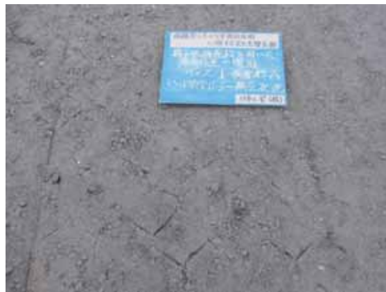
写真-7.1.3-4 段差擦り付け・復旧作業, 転圧状況: 格子状補強材 A
