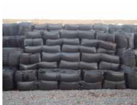
4) 正面から撮影（全段設置）
