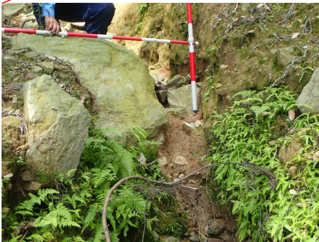
写真 4.1.3 流域下流部における溪床侵食の状況（水位計2の上流地点）
