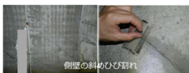
写真-2 側壁の斜めひび割れ
