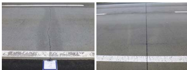
写真 1 横断ひび割れの例
