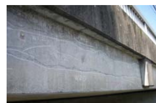
図-4 ひび割れ発生状況
