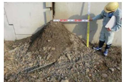
写真-1 盛土材のこぼれ出し
