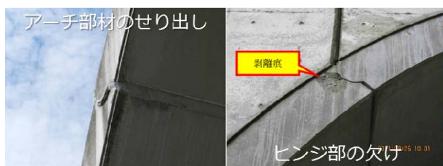
写真-3 ヒンジ部の変状
