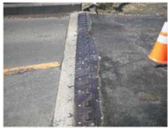
写真-4.2.16.6 A1 橋台部の伸縮装置の 目閉じ (資料提供：宮城県)
