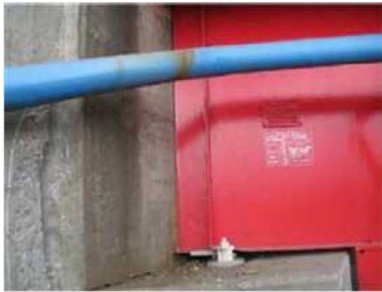
写真-4.2.16.2 A1 橋台部 G3 主桁遊間異常 (0mm) (資料提供：宮城県)
