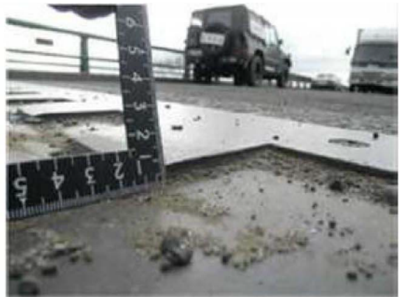
写真-4.2.16.7 A2 橋台部の伸縮装置の段差 (8mm) (資料提供：宮城県)
