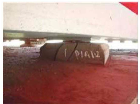
写真-4.2.16.5 P1 橋脚部の可動側変位制限 アンカーバー台座コンクリートのひび割れ (資料提供：宮城県)
