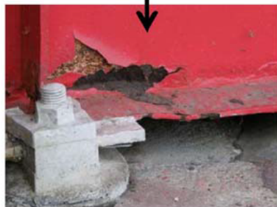
写真-4.2.16.11 橋台に生じたひび割れ 及び鋼桁の塗膜のはがれの状況
