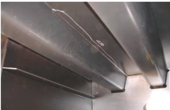
鋼床版の亀裂
