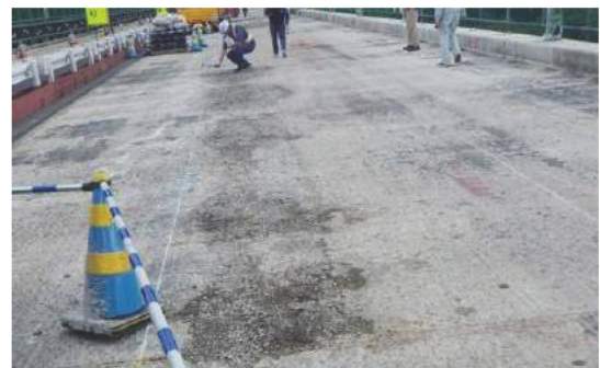
写真-3.3.5 RC 床版上面の土砂化事例
