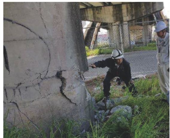
写真-2.2.5 熊本地震における道路橋の被災調査
