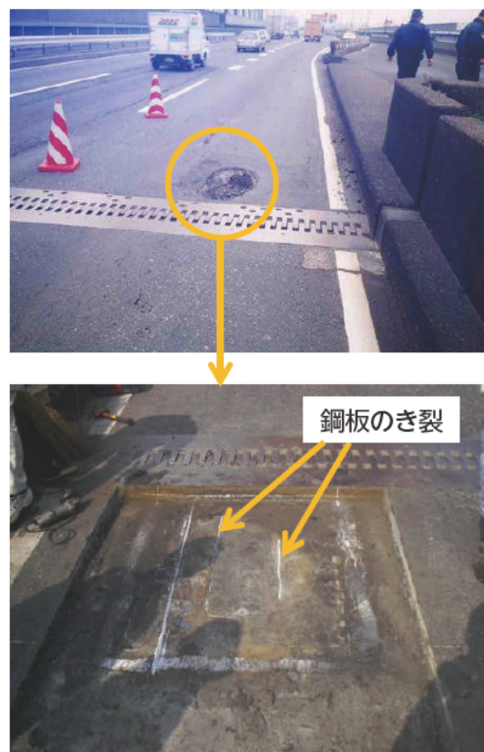
写真-3.3.1 鋼床版デッキプレートの疲労による貫通き裂
