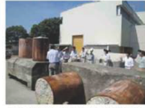
橋の撤去部材見学会(鋼製パイロメント腐食の腐食状況)
