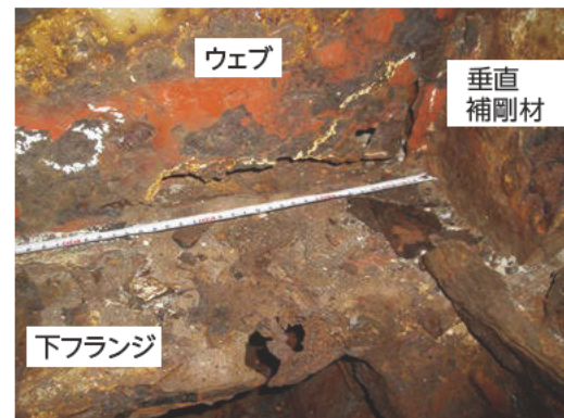
写真-3.3.4 鋼桁端部の著しい腐食事例
