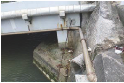
横締めPC鋼棒の抜け落ち
