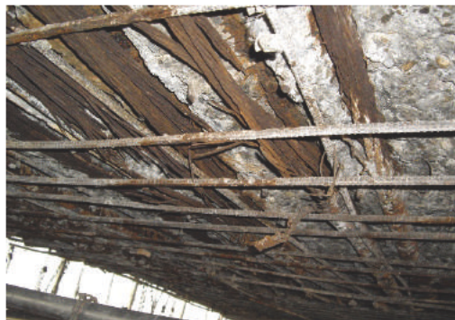
PC鋼線の破断
