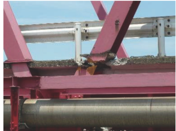
写真-1.1.2 木曾川大橋のトラス斜材破断
