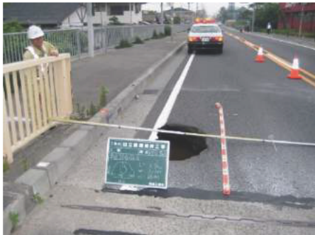
写真-2.2.1 稲村橋における橋台洗掘による路面陥没
