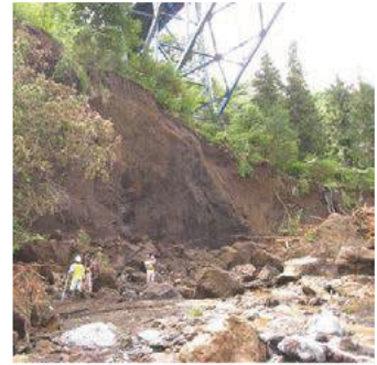
写真-2.2.3 台風9号による須川橋の浸食
