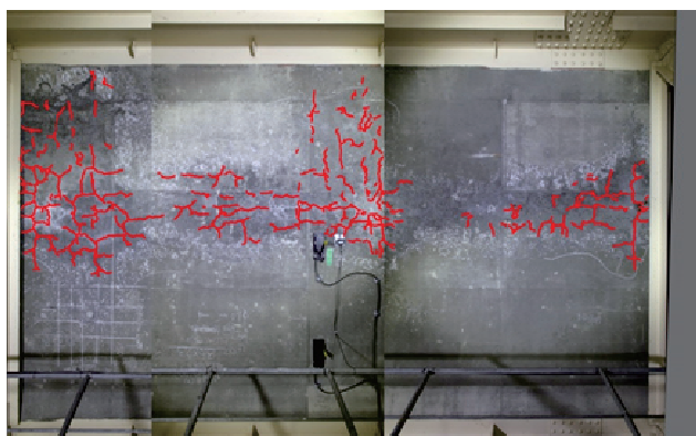
図-4 ひび割れ分布図の一例
