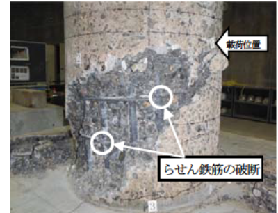
写真-1 Case3における損傷状況
