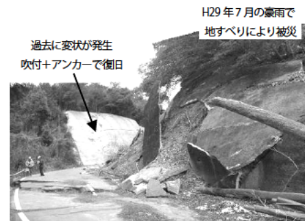
写真-1 近接斜面での異常確認事例
