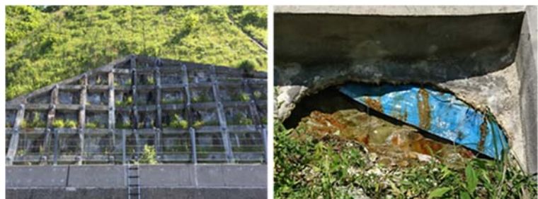
写真-1 のり面遠景(左)と崩落部から見える濡れた地山(右)
