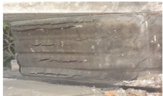
写真-1 ゴム支承のオゾン劣化によると考えられる亀裂の例
