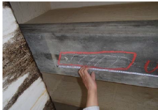
図 2 モルタル浮き部
