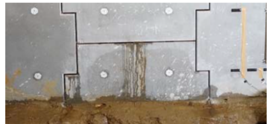
写真-3 目地部からの排水状況(最下段)
