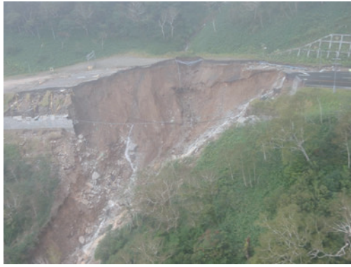
写真-5 H28年台風10号での盛土崩壊 (国土交通省 北海道開発局 帯広開発建設部 HP より)
