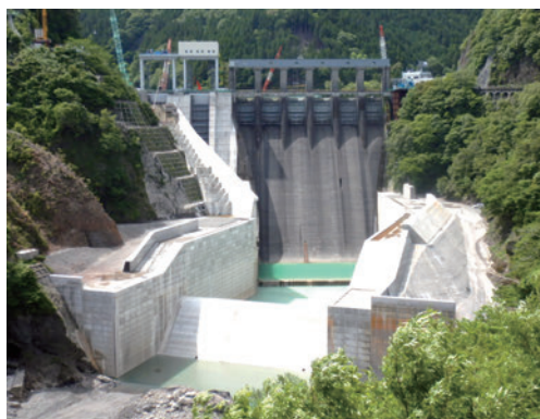
図-4 長安ロダム(改造工事中) (那賀川河川事務所ホームページより)
