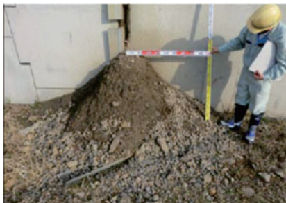
写真-3 補強土壁の盛土材のこぼれ出し
