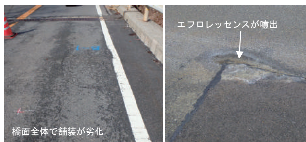
写真-4 舗装面に生じた変状（治部坂橋）
