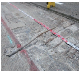
写真2 砂利化(鉄筋露出)
