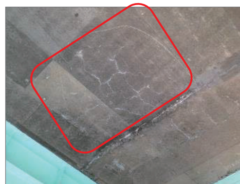
写真-3. 舗装異常個所の直下(横断方向ひび割れ・遊離石灰) 補修境界から遊離石灰。
