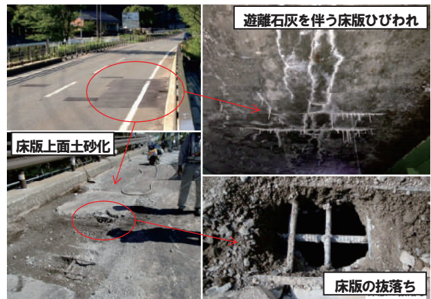
写真-1 土砂化による床版の抜け落ち状況（第二恩田橋）
