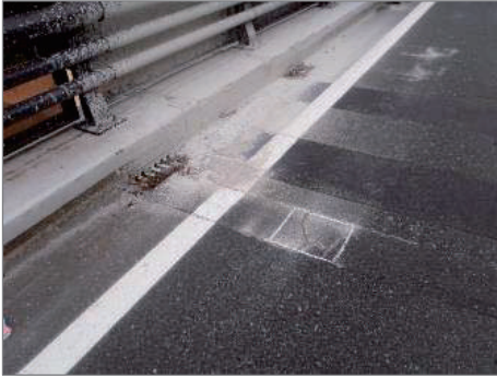
写真-1. 白い噴き出し。過去に全面的舗装・防水施工。下面是グレーチング床版。
