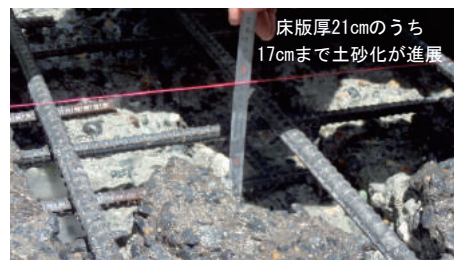
写真-7 土砂化深さ（治部坂橋）
