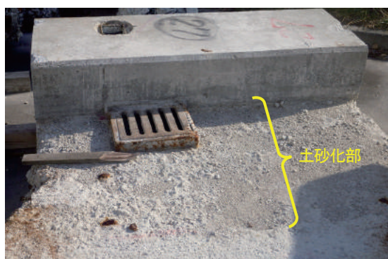
図-2 地覆、排水口付近の土砂化の事例 (Ka橋)
