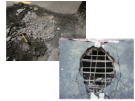
土砂化した床版（左）と舗装の抜け落ち（右）
