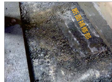
写真-3. 過去の床版上面補修箇所は浮き、周辺では土砂化
