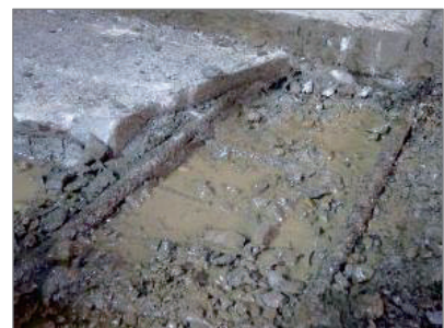
写真-3. 床版上面の滞水・土砂化
