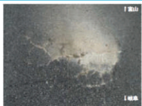
舗装のひびわれと土砂噴出跡
