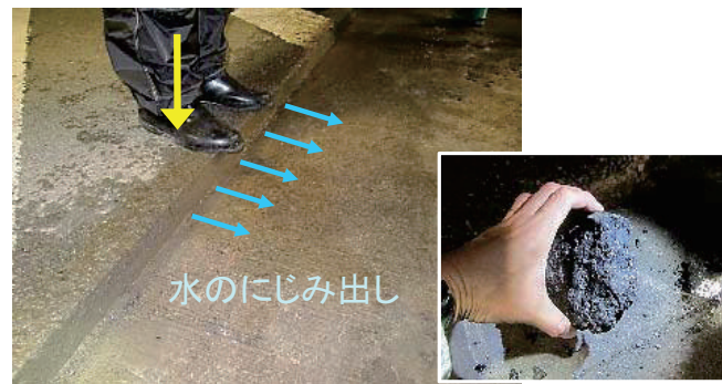
写真-3. 防水工とコンクリート面境界から水のにじみ出し。右：アスファルトの骨材剥離。
