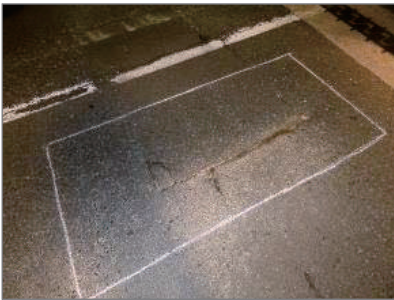
写真-1. 路面As舗装から土砂噴出し
