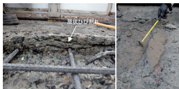
写真-6 床版上の層状のひび割れ（治部坂橋）
