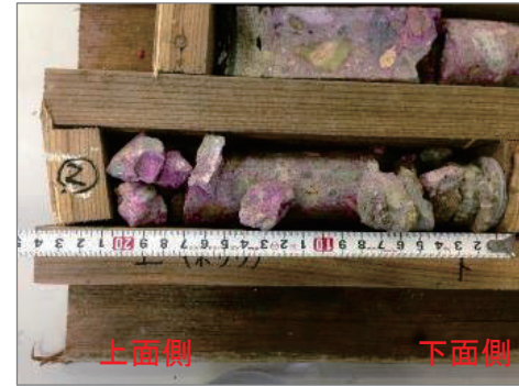
写真-4. 床版コンクリートコア採取は劣化のためコア形状として採取できず
