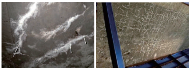
a) 漏水・遊離石灰 b) 格子状のひび割れ 写真-3 床版下面の異常
