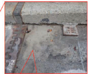
雨水が滞りし床版が劣化
