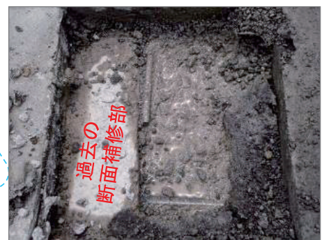
写真-4. 過去の補修隣接部の劣化
