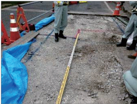
写真-1. 舗装補修時に舗装版撤去で広範囲の土砂化を確認
