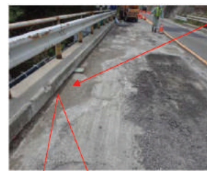
地覆の舗装目地から浸水し湿潤
