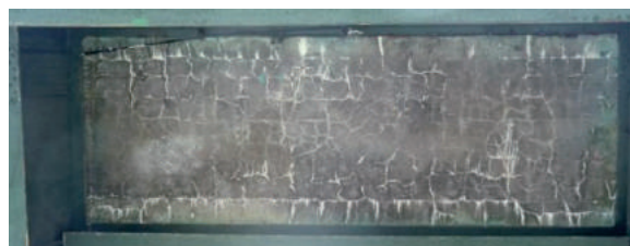
写真-1 床版下面の遊離石灰
