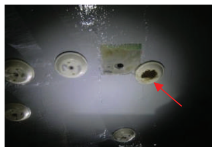
炭素繊維補強部からの土砂流出
