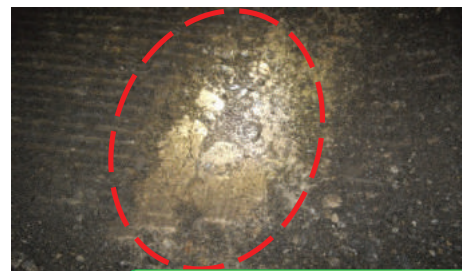
舗装を剥ぐと一見 コンクリートに見える
