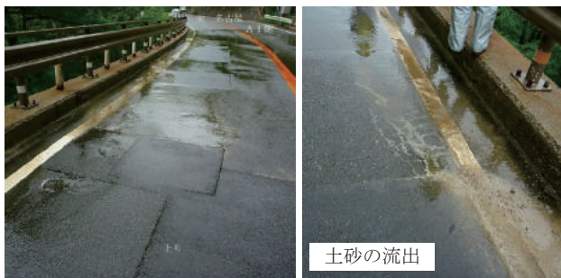
写真-9 舗装面に生じた変状（第一横岳橋）
