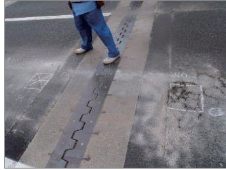
写真-3. 更新時に横断方向に排水パイプ設置後、ひび割れのため撤去。防水の不連続あり
