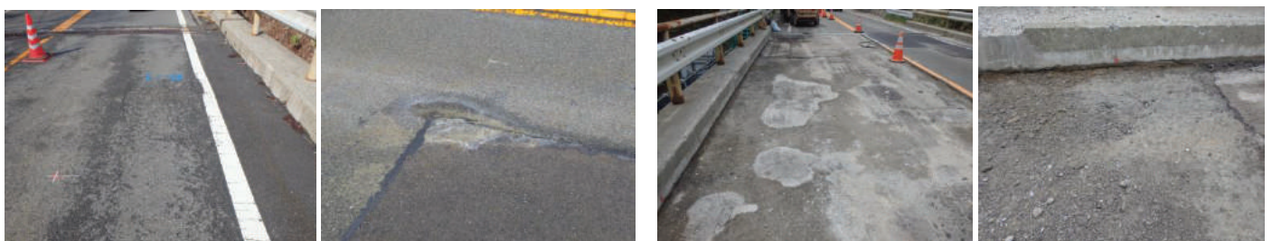
舗装面に生じた変状
