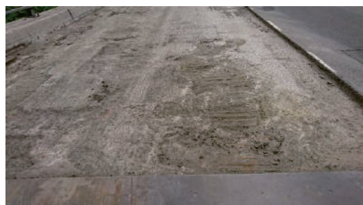
写真-10 鉄筋の露出
