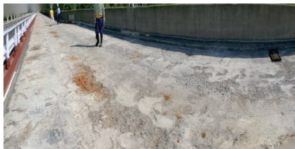
写真-1 舗装開削後の土砂化が進行した事例
