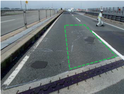
写真-1. 路面As舗装の補修痕から土砂噴出し
