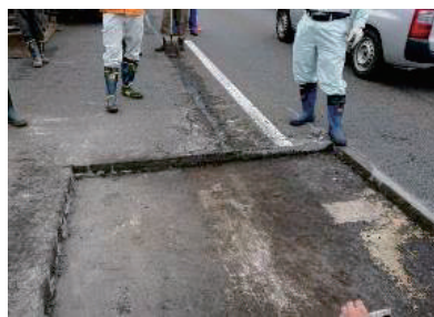
写真-2. 舗装と防水面の間に滞水。 床版はまだ健全。
