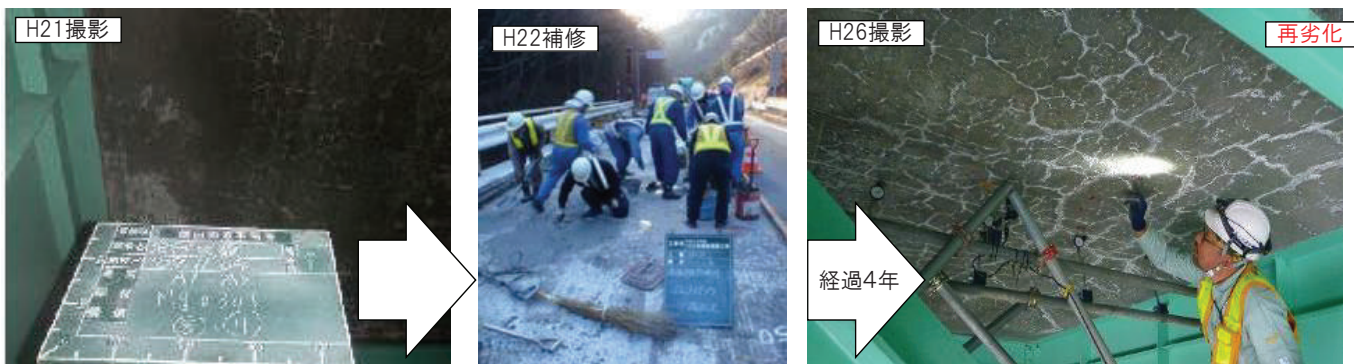
H21に床版劣化を確認。翌年補修工事を実施するも、4年後の点検で床版が再劣化。亀甲状のひび割れと土砂化が発生
