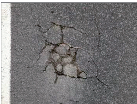
写真-2. 路面As舗装(近接) 土砂を含んだ噴き出し
