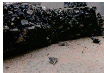
写真-3. アスファルト劣化断面(骨材剥離)
