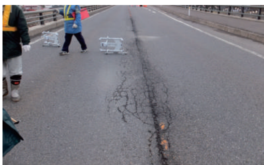
(b) 舗装を剥がす直前の状況、ただし撮影方向は逆向き
