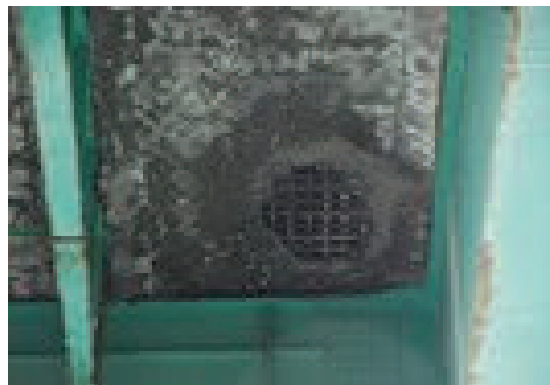
床版下面の抜け落ち
