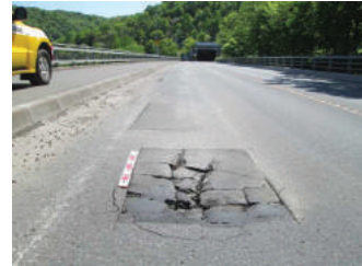
舗装補修後の再劣化
