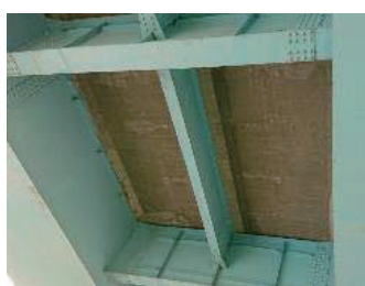
写真-2. 一部の床版で橋軸直角方向のひび割れ・漏水確認
