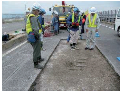
写真-2. 舗装ポットホール箇所以外でも広く土砂化が進行
