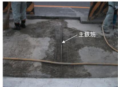
土砂化やうきを除去した床版上面
