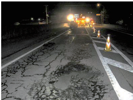
写真-1. 路面As舗装に網目状の無数のひび割れ・補修痕（主に走行位置）
