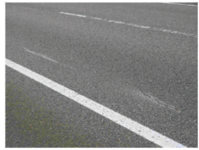
舗装の損傷状況(第5径間)
