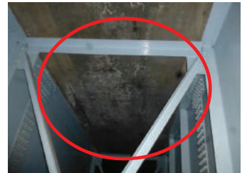
2方向ひび割れや遊離石灰の滲出が見られる
