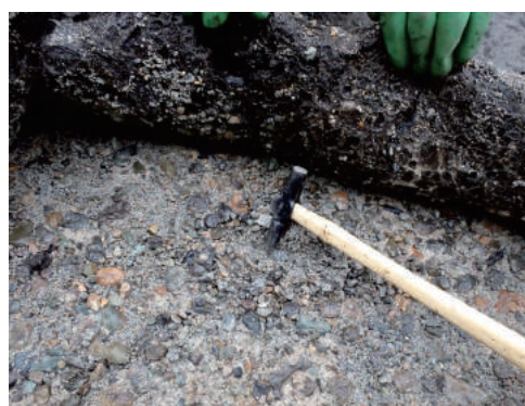
図-5 防水層下の土砂化の事例 (T橋)
