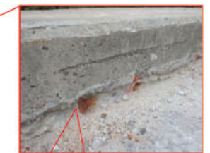
地覆付け根部分は土砂化
