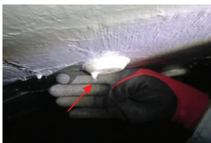
炭素繊維補強部からの漏水
