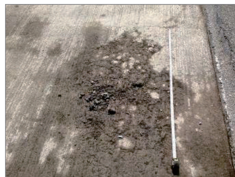
写真-4. (舗装撤去後)土砂化の深さは上面鉄筋まで達していない
