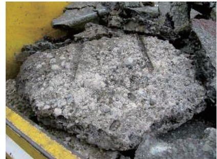
写真-3. 舗装と一緒にコンクリートが剥がれた舗装裏面
