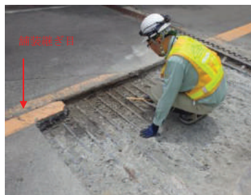
舗装の継ぎ目(センターライン)での床版土砂化
