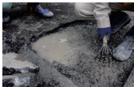
写真-11 土砂化状況（第一横岳橋）
