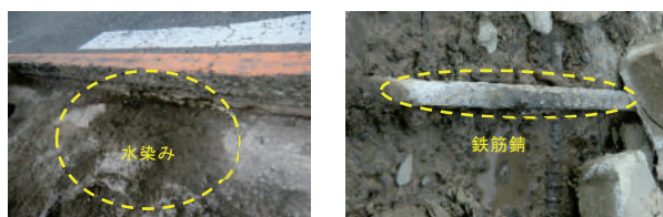
(a) 防水層下の水染み (b) 床版鉄筋の錆 写真-5 土砂化した床版内部の状況
