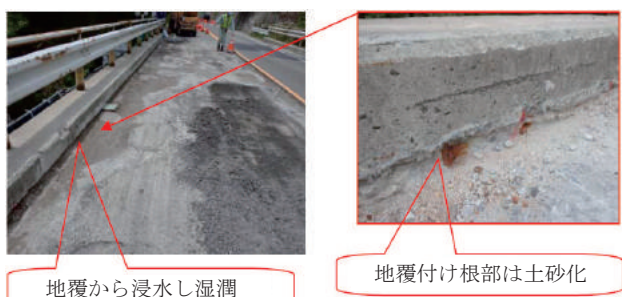
写真-8 土砂化状況（治部坂橋）
