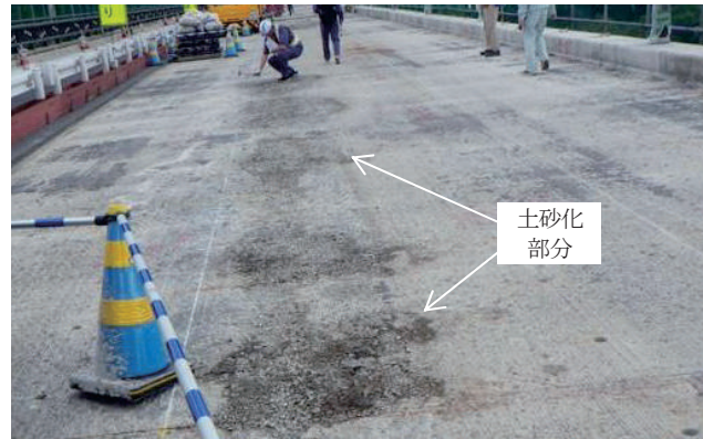
写真-2.4 舗装打継目付近下の床版コンクリートの土砂化 (舗装を剥がしたところ)
