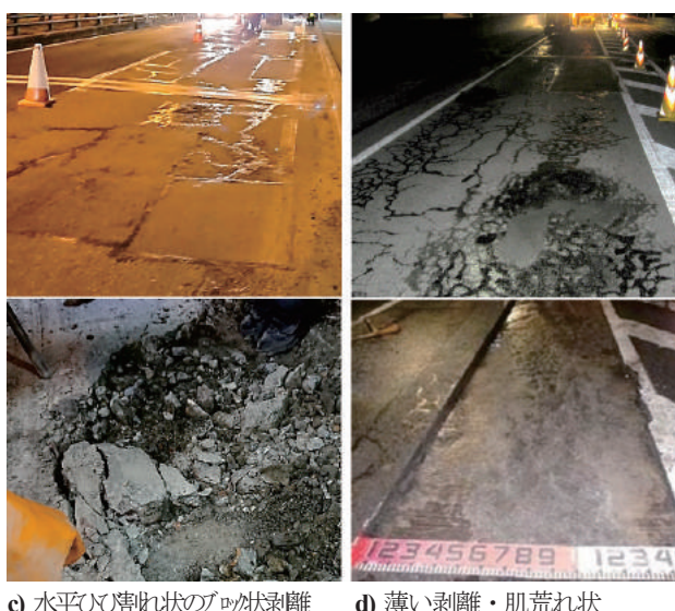
写真4 床版上面の脆弱状態の種類 (上段: 路面、下段: 床版上面)
