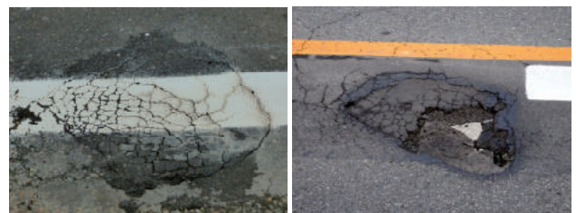
写真-2 床版上面(橋梁上の舗装)の異常
