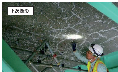
写真-2 床版打替対策後の床版下面の損傷状況（治部坂橋）
