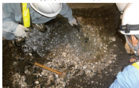
(b) 鉄筋が露出するまで工具で掘れる状態
