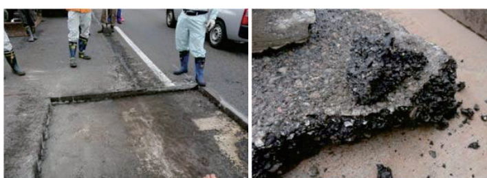
写真-3. 4. 床版面に異常なし。アスファルトは劣化（骨材剥離・もろい。約20年経過）
