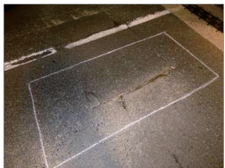
写真-1. 過去に床版上面補修した路面As舗装に土砂混じりの噴き出し
