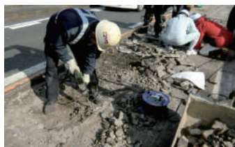
写真-2 土砂化した床版
